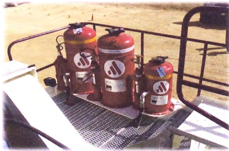
Fig. 4.18: Tanques con agentes químicos instalados
