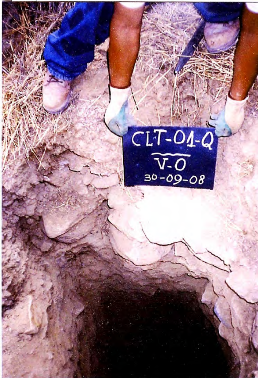
Foto N° 12.- Excavación realizada en el vértice V-0A, en la primera estructura de salida de la subestación Huallanca 138 kV a Subestación Quitaracsa.
