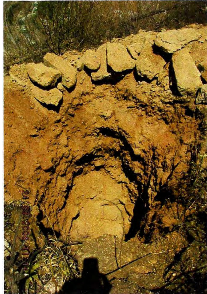
Foto N° 06.- Calicata CLT-H-04. Se observa los fragmentos rocosos extraídos de la excavación en un porcentaje aproximado de 60 -70%. Estos fragmentos presentan con un grado de alteración moderado.
