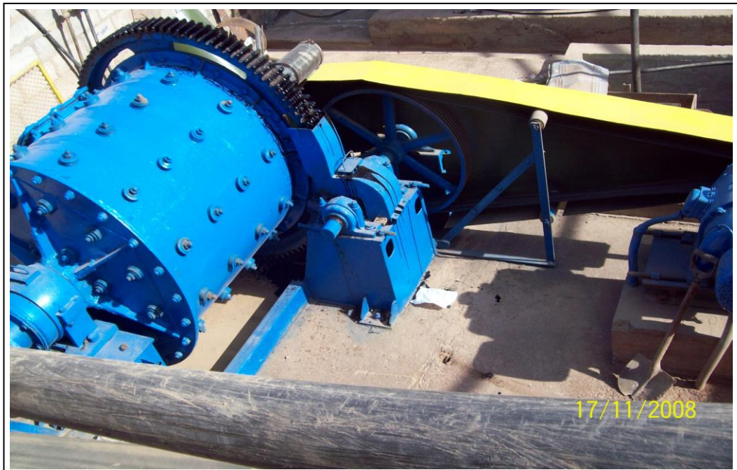
Foto 2.2-19. Molino Denver 4'x4', luego de cambio de chaquetas. Se inicio con 25TMSD las operaciones
