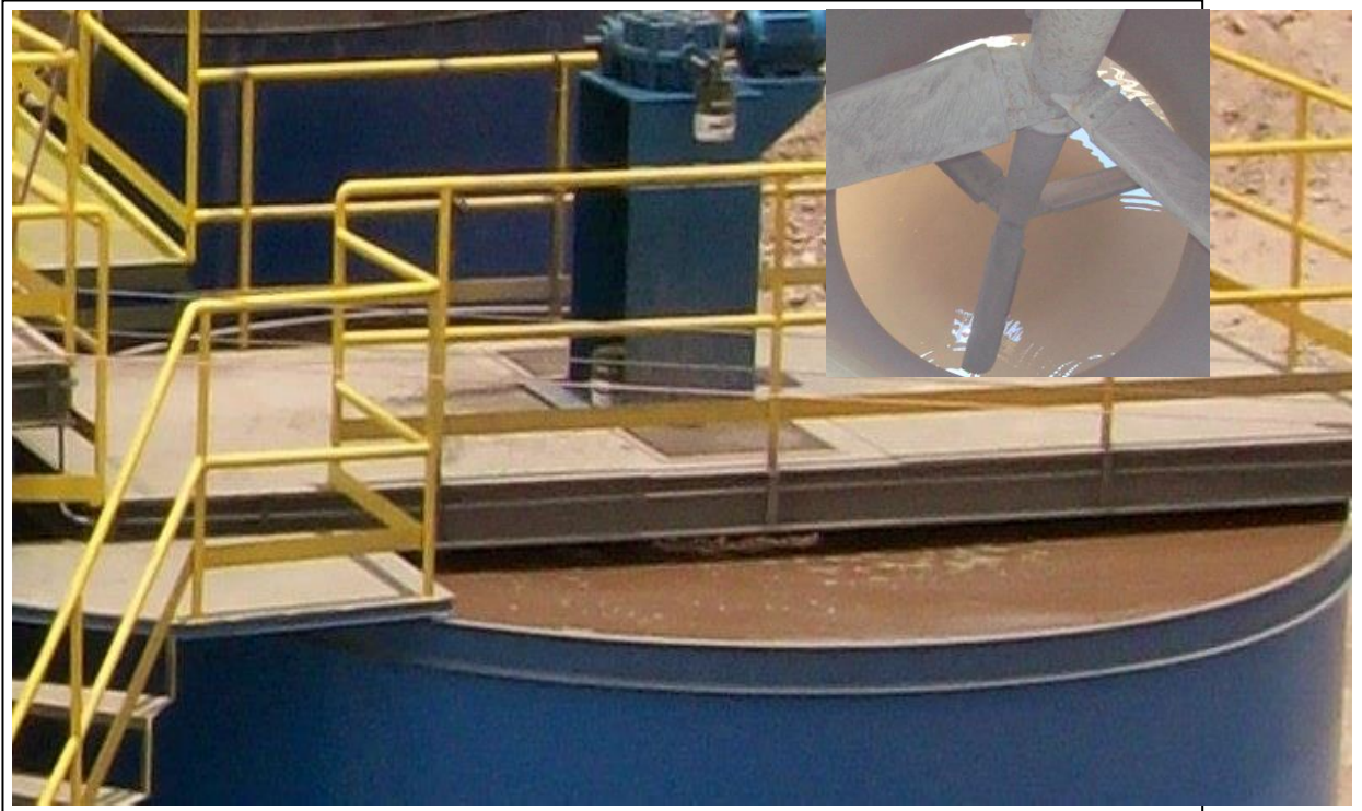
Foto 3.3-5. Superficie de tanque 18'x18' (velocidad de agitación 30rpm, estos tanques cuentan con dos impulsores) la pulpa recirculando por el Draf, al igual que el tanque 12'x12' (velocidad de agitación 30rpm ) la suficiente agitación que permite mantener la pulpa aireada.
