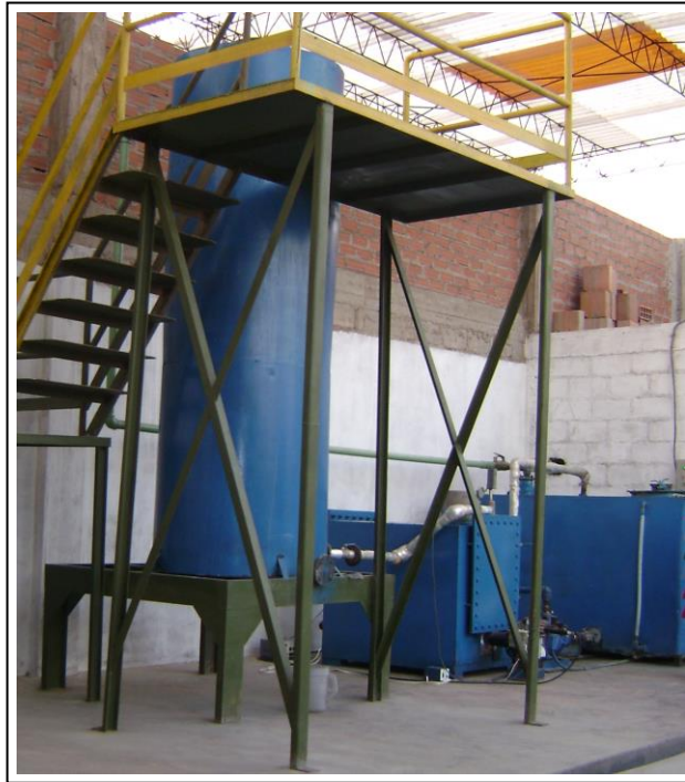
Foto 2.2-33. Reactor, Caldero, tanque de paso, bombas, celda electrolítica y rectificador (en la foto no se van a observar)
