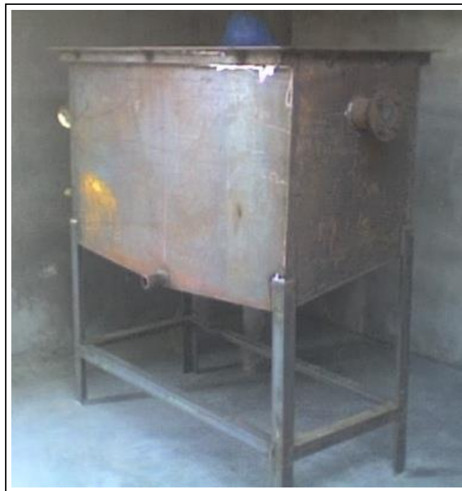
Foto 2.2-34. Celda electrolítica en plena construcción, antes de ser revestido con fibra de vidrio.
