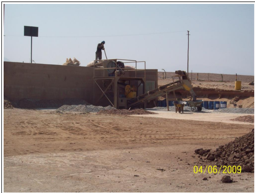
Foto 2.2-8. Circuito abierto para lote menores a 2TM
