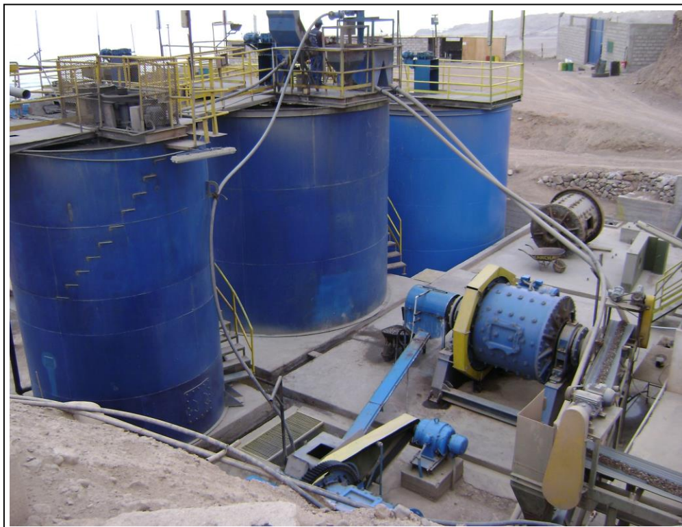
Foto 2.2-25. Tanque alargado 12'x18' y 4 tanques 18'x18' con un tiempo de retención para 80TMSD de 96 horas, se ha montado el hidrociclón, el DSM y la cosechadora de carbón sobre el tanque, con el montaje del tercer molino se va a incrementar a 120 TMSD con un tiempo de 64 horas de retención.
