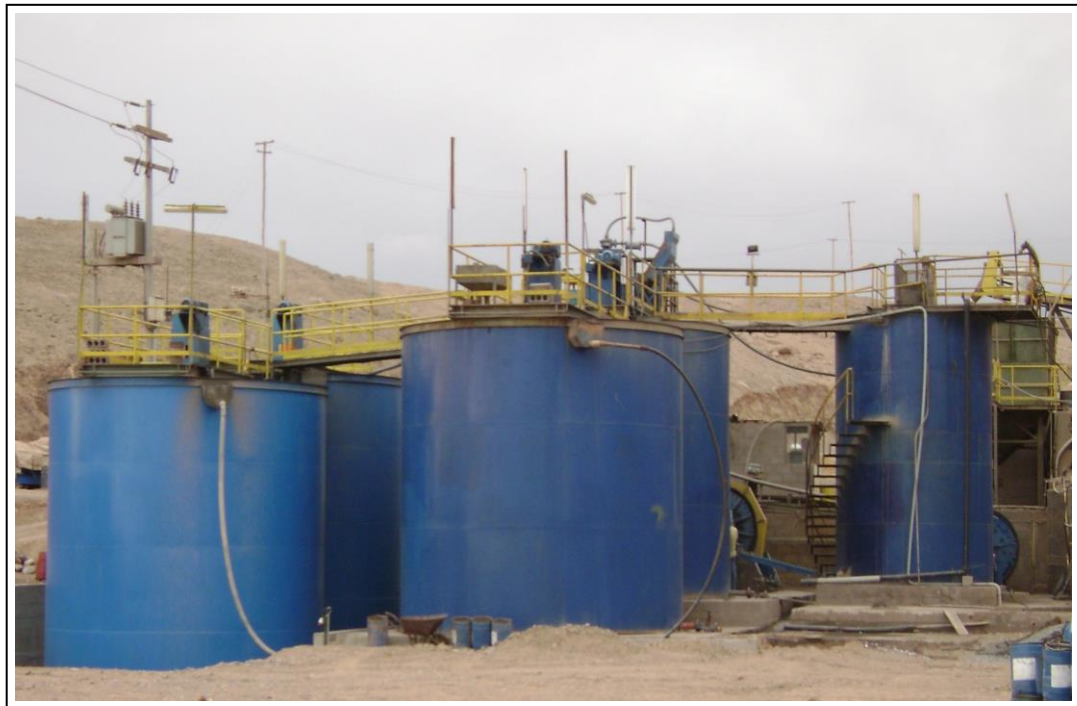
Foto 2.2-31,32. Situación actual de los tanques y molinos, 4 tanques 18'x18' y el tanque N° 1 alargado (tanque principal), los dos tanques 12'x12' se convirtieron en tanques de recepción de solución barren., los tanques 18'x18' N° 4 y 5 se encuentran enterrados a 1.5 metros, se va a construir dos tanques mas de 18'x18' que remplazaran al tanque alargado. Los dos molinos se encuentran al fondo de la foto, se esta preparando el tercer molino. Asimismo se observa el transformador de 22.9/0.44.
