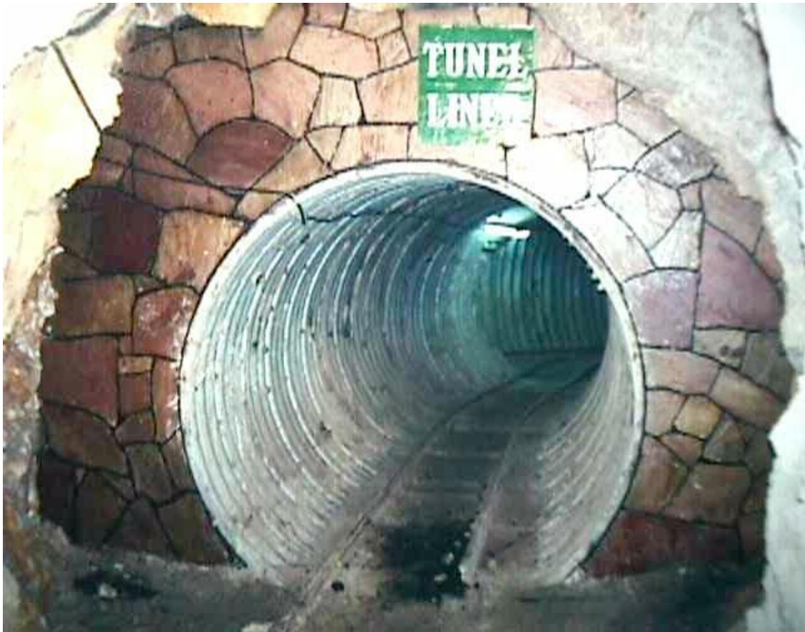
Figura N.1. Tunel Linner instalado en la Galería 095, de la veta victoria.
