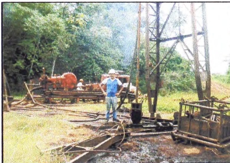
FOTO N° 20 AL FONDO, BOMBAS TRIPLEX
