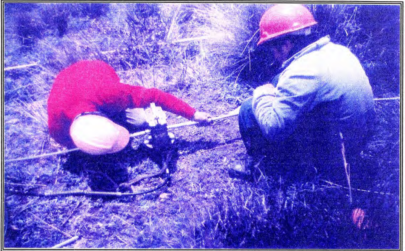
Foto N°. 03: Empalme del Conductor. Entre las Torres N°. 43 y 44.
