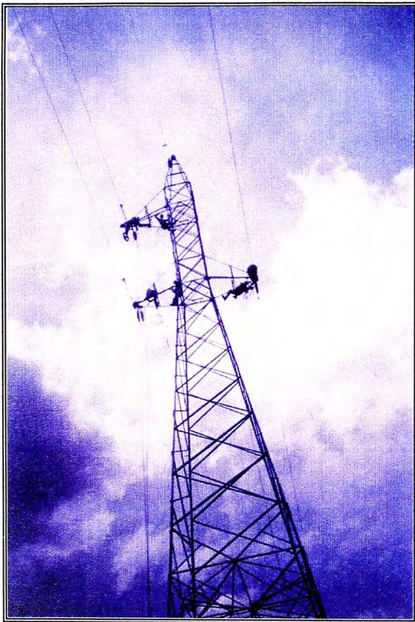
Foto N°. 5: Flechado y Empalme de Terminal Las 03 Fases y el Cable de Guarda en la Torre N°. 58
