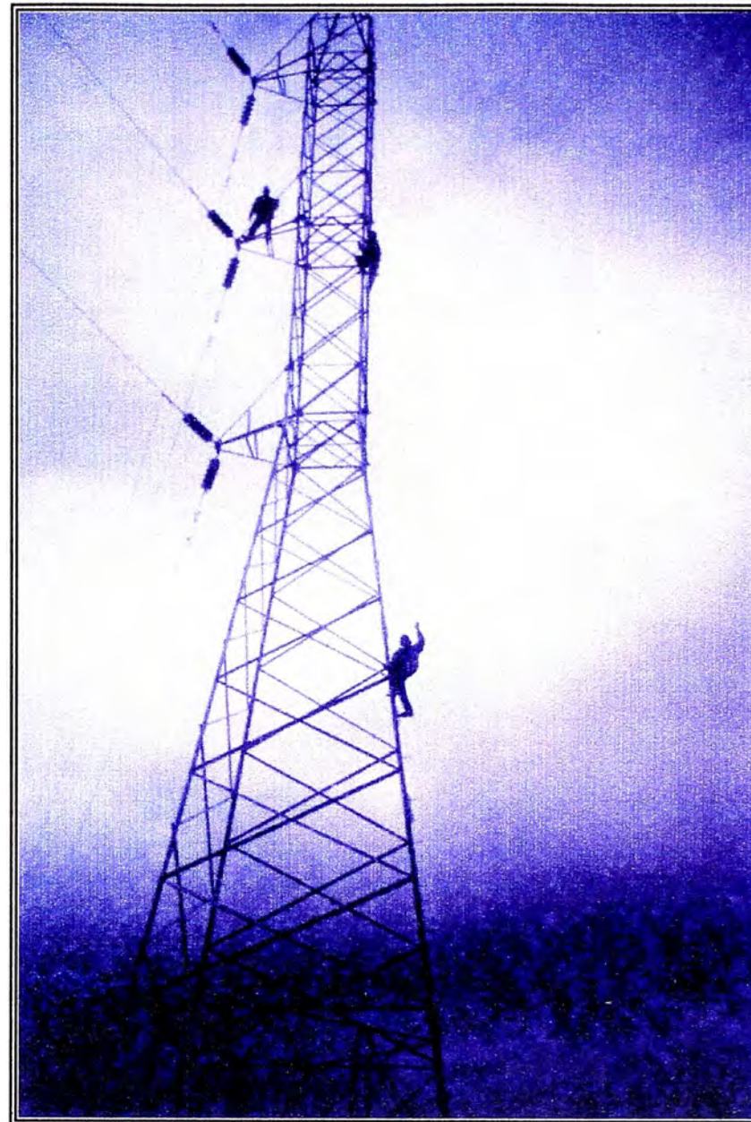
Foto N°. 6: Tendido del Conductor y del Cable de Guarda terminados. Entre las Torres N°. 29 y 45
