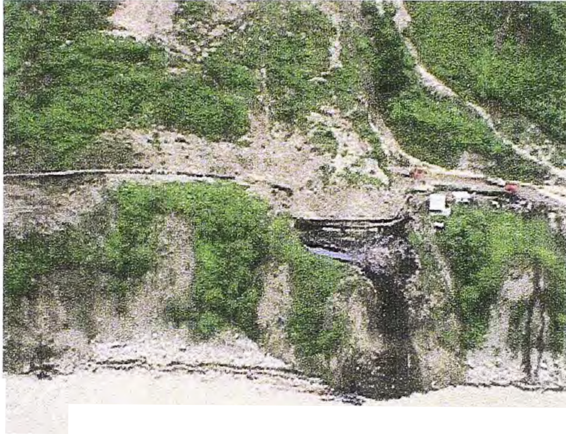
Colapso de poza de confinamiento por incremento de deslizamiento (14-05-1999)
