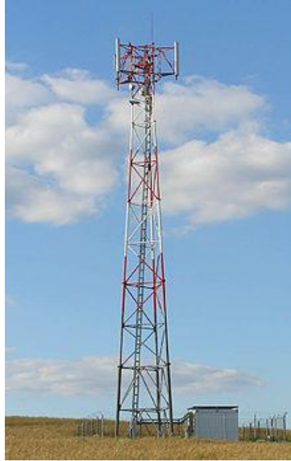
Figura 2. 3: Torre BTS que mantiene la antena.
