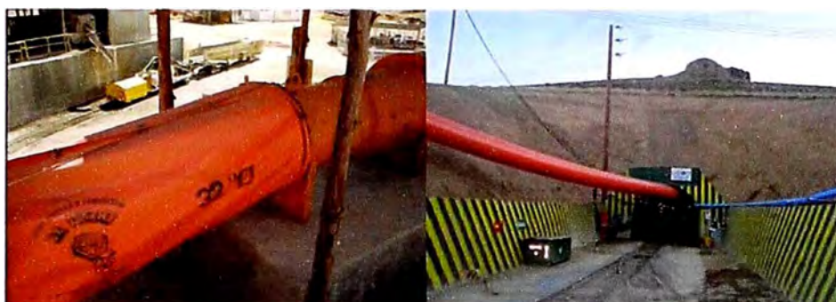
Figura 7. Ventilador y manga de ventilación.
