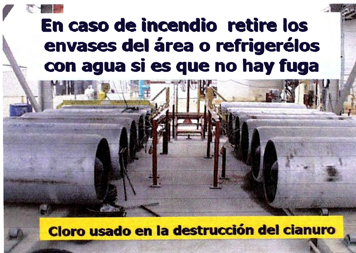
Figura 23. Tanques de Cloro
