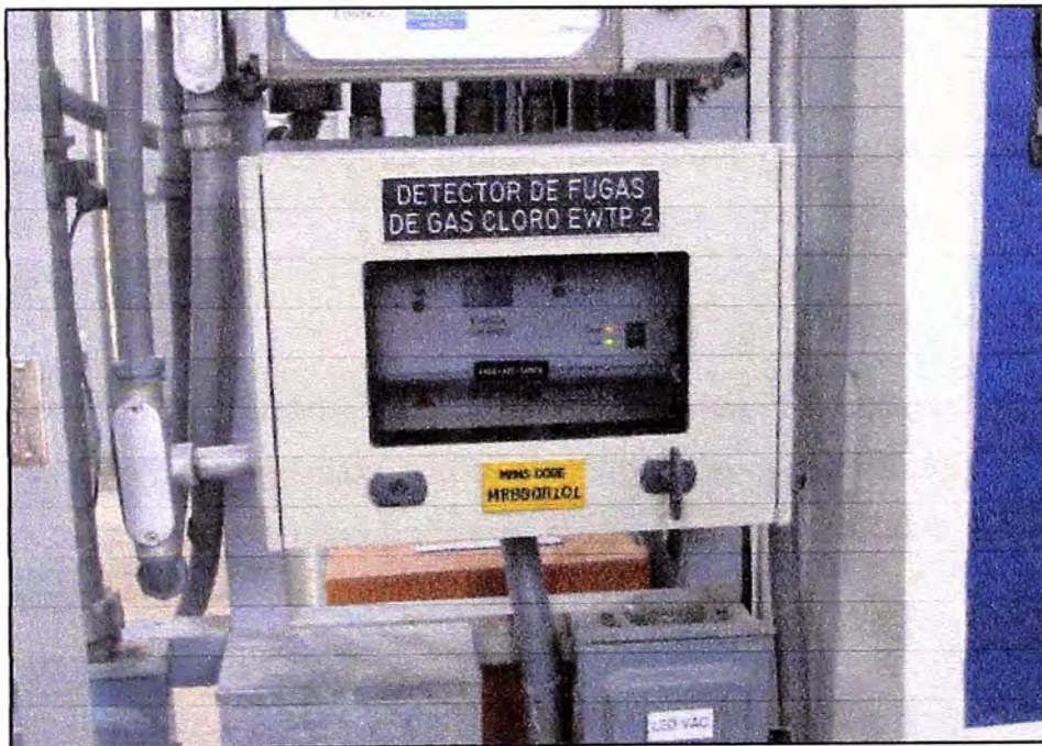
Figura 25. Detector de fugas de Gas Cloro
