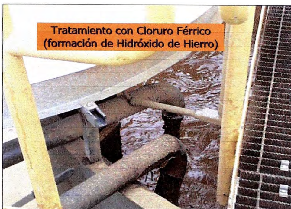
Figura 6. Tanque de Cloruro Ferrico.
