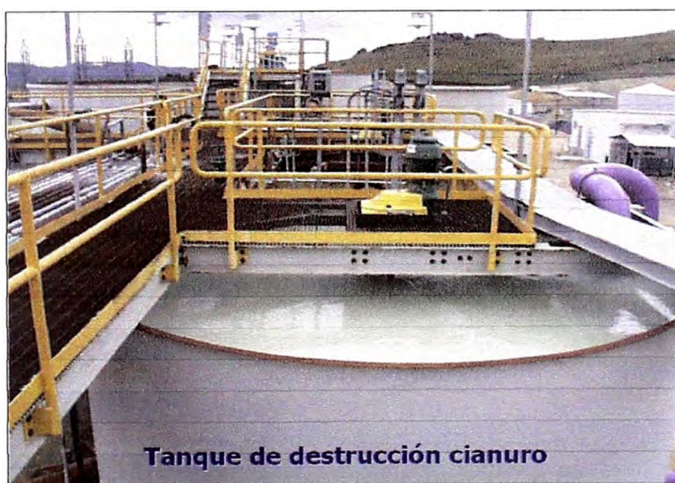
Figura 4. Tanque de destrucción de cianuro.
