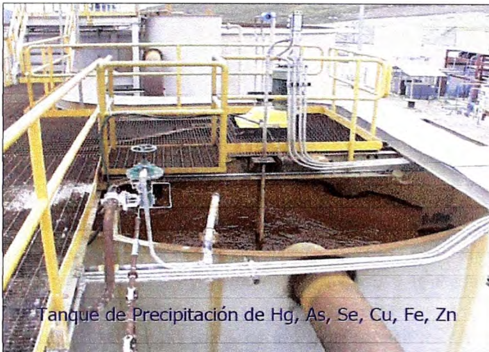
Figura 5. Tanque de precipitación de metales disueltos.
