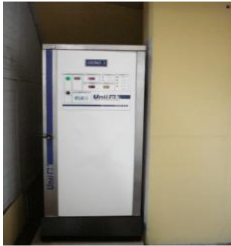
Fig.2.7.1.1.7 Generador de ozono
