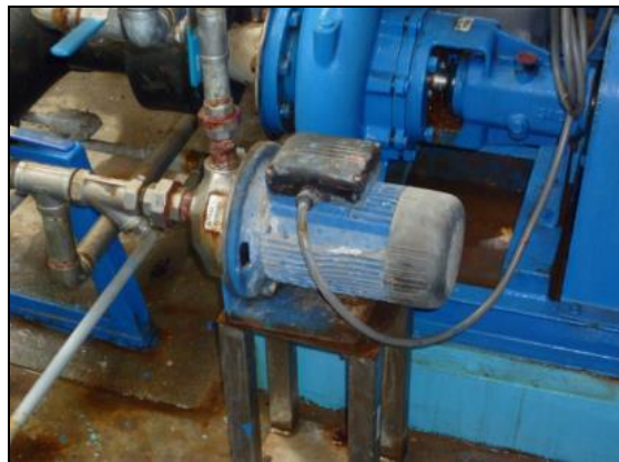
Fig.2.7.1.1.8 Bombas de los generadores de ozono
