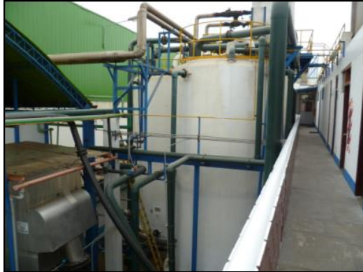
Fig.2.7.1.1.10 Tanque de reposición
