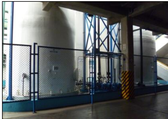
Fig.2.7.1.1.11 Tanque de almacenamiento
