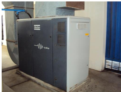
Fig.2.7.5.1.2 Compresor de aire
