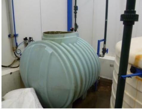
Fig.2.7.6 Tanque almacenamiento de agua dura
