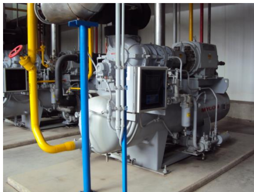
Fig.: 2 Compresor tornillo
