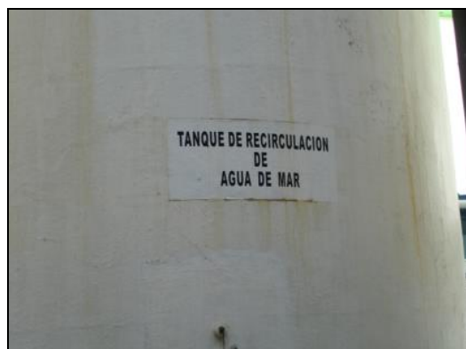
Fig.2.7.1.1.9 Tanque de recirculación
