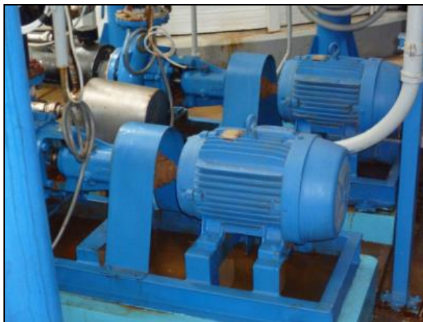
Fig.2.7.1.1.5 Bomba de recirculación
