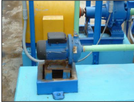
Fig.2.7.1.1.3 Bomba a planta hielo
