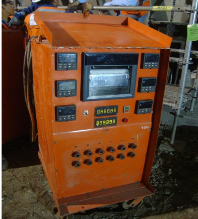
Fotografía N° 4.3 Equipo de calentamiento por resistencia eléctrica.
