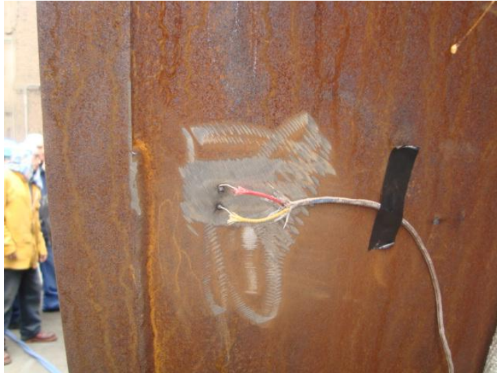
Fotografía N° 4.6. Termocupla instalada en superficie de tubería
