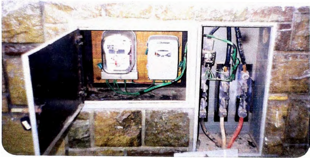
FOTO 1 Acometida entre caja toma y medidor.
