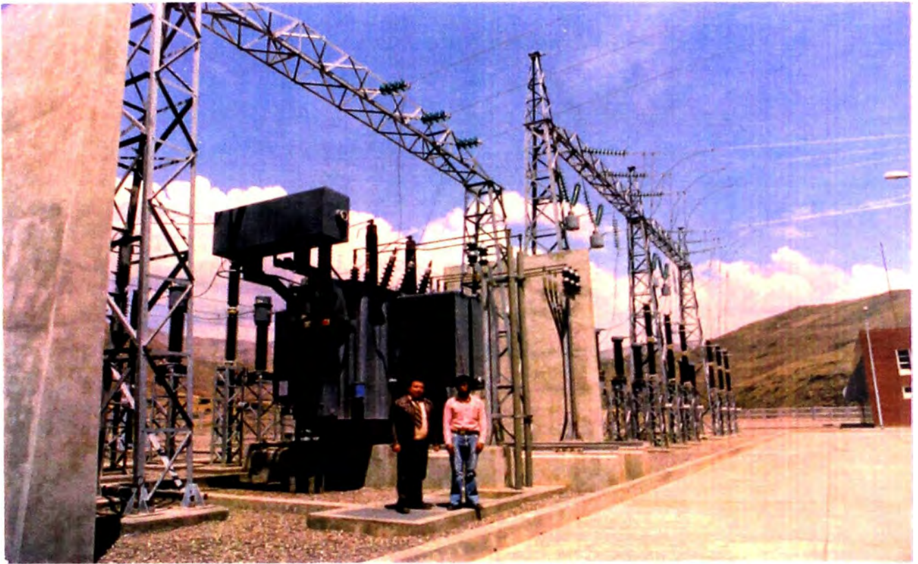
V-11: S.E QUENCORO TRANSFORMADOR DE POTENCIA
