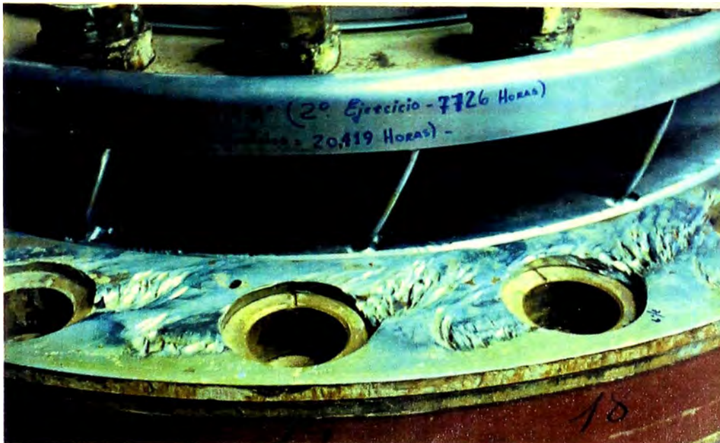
V-6: DETALLE DE DESGASTE TURBINA FRANCIS CHM
