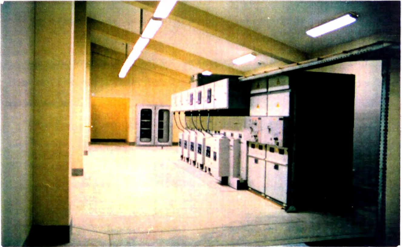
V-14: S.E TINTAYA CELDAS DE LLEGADA Y DE DISTRIBUCIÓN 10 KV
