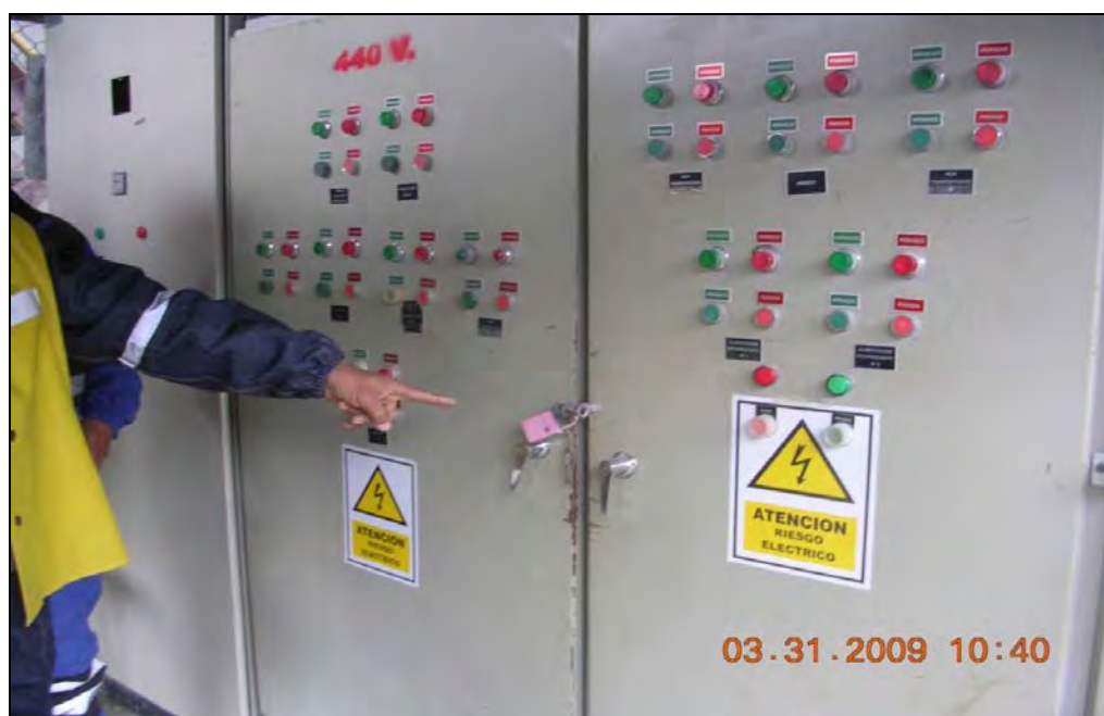
Fotografía N° III – 19: Tableros eléctricos rotulados
