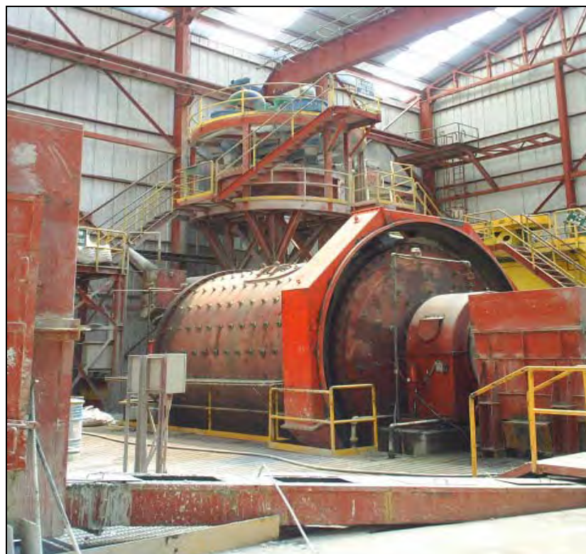
Fotografía N° III – 22: Sistema de protección en Plana Concentradora
