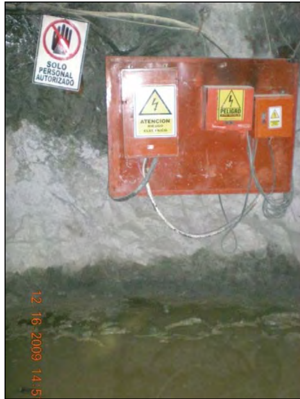
Fotografía N° III – 14: En el interior de la mina, falta incrementar el pintado de cables eléctricos con el Código de Colores.
