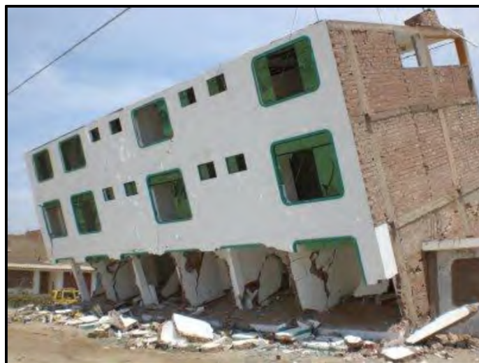
Figura 2.11. Daño observado en las edificaciones luego del terremoto de Pisco del 15 de agosto del 2007.
