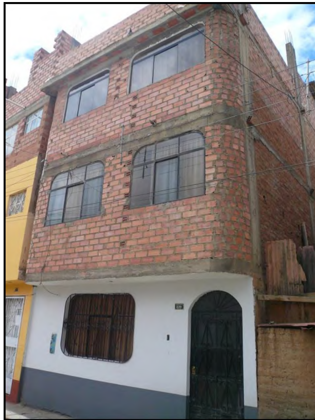
Figura 5.4.- Edificación de albañilería con parapetos no confinados en sus aleros.
