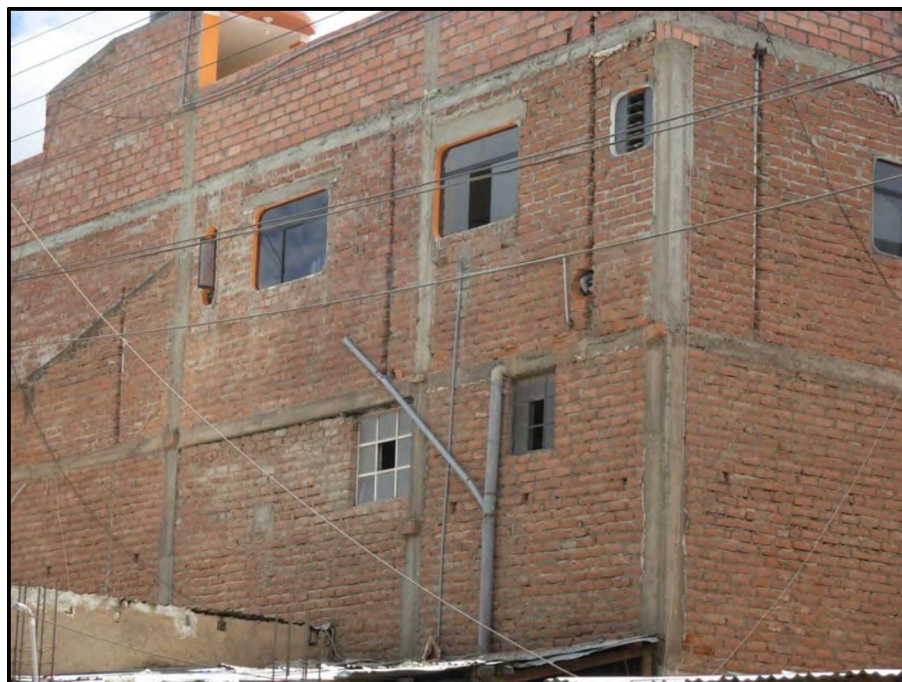
Figura 7.10.- Edificación con instalaciones sanitarias que cruzan elementos estructurales.
