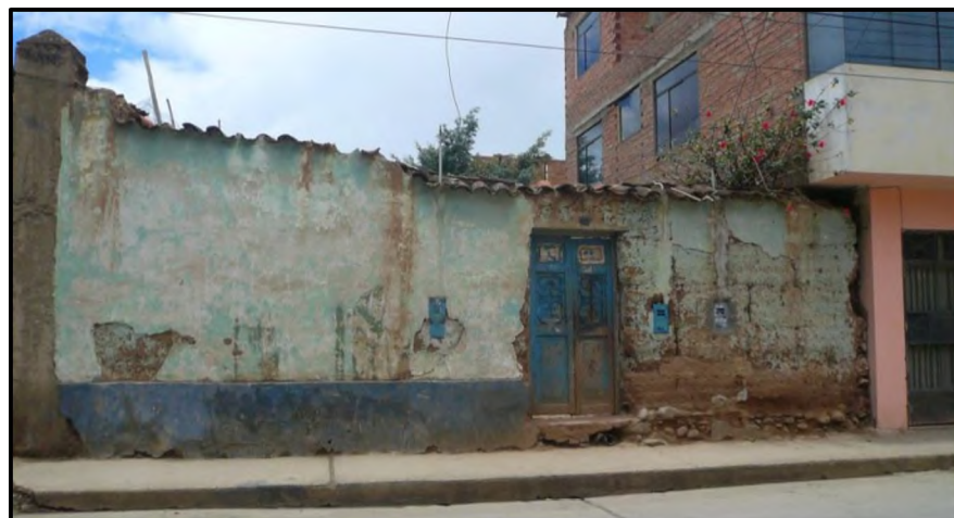
Figura 7.13.- Edificación de adobe con presencia de humedad en el sobrecimiento y muros.
