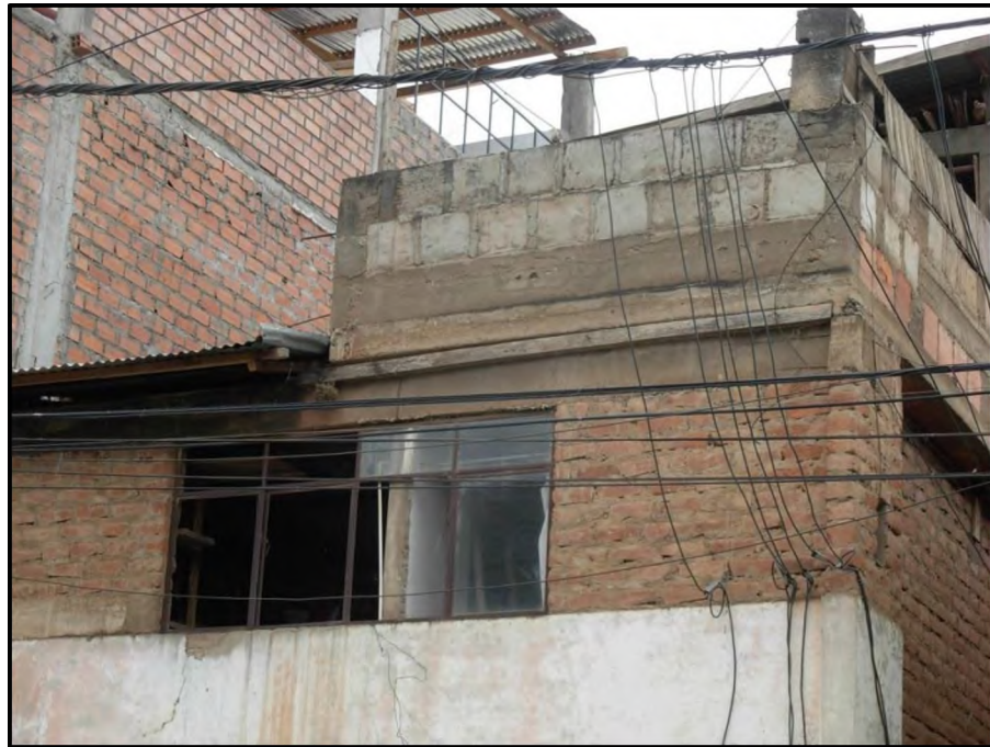
Figura 7.6.- Sistema resistente y unidades de albañilería no homogénea y de mala calidad.
