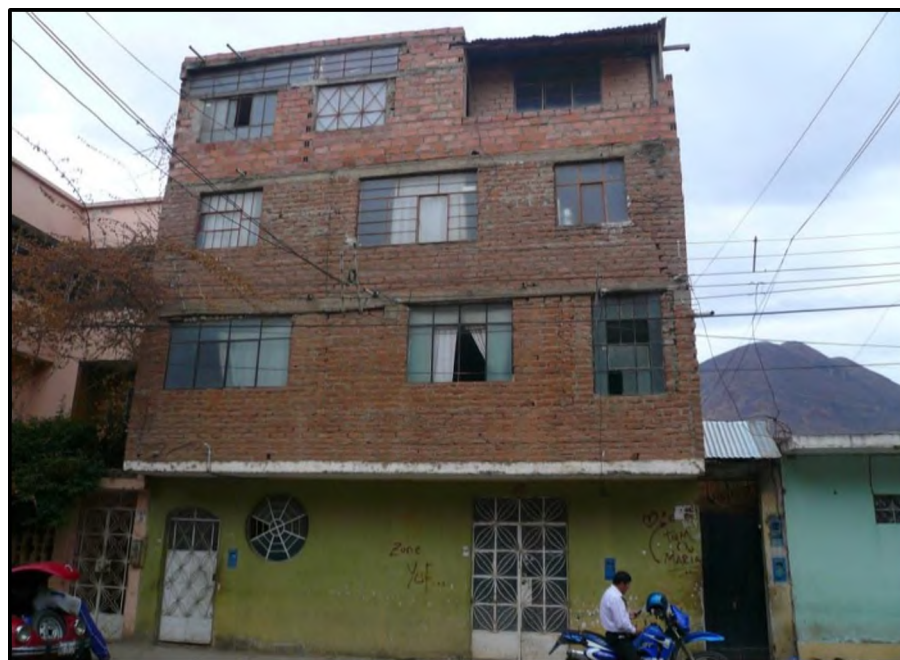
Figura 7.2.- Edificio de albañilería sin un adecuado confinamiento vertical.
