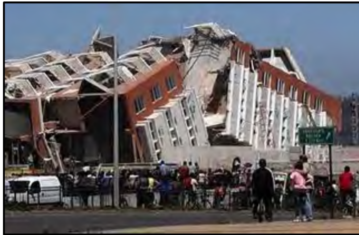
Figura 2.12.- Daño observado en las edificaciones luego del terremoto de Chile del 27 de febrero del 2010.
