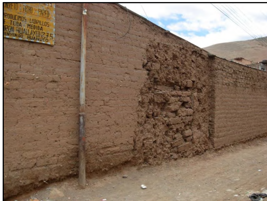
Figura 7.5.- Mampostería de adobe no homogéneo y de mala calidad.
