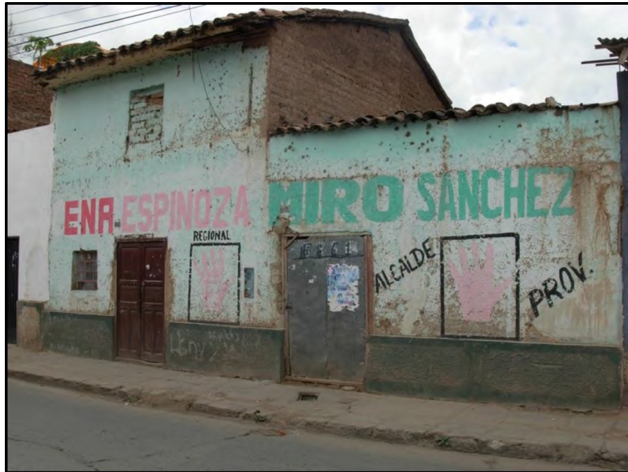
Figura 7.30.- Edificación de adobe en mal estado de conservación.
