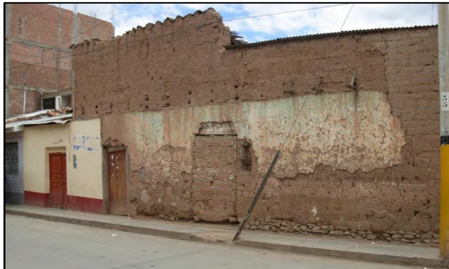
Figura 7.1.- Edificación de adobe sin arriostramiento horizontal y vertical.
