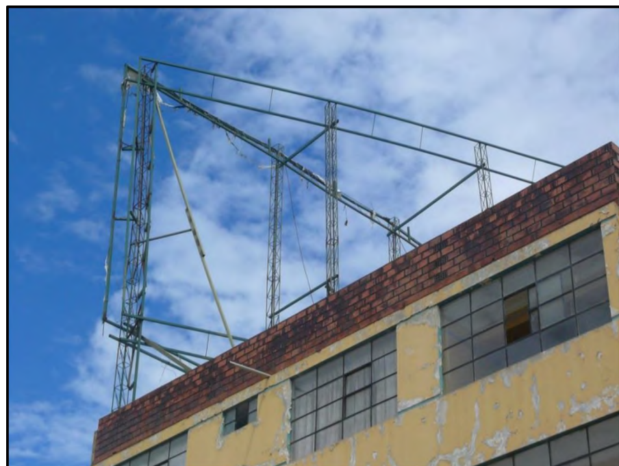
Figura 7.28.- Panel publicitario de acero colocado en la azotea de la edificación.
