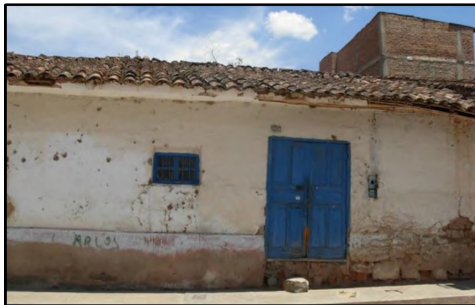
Figura 7.15.- Edificación de adobe con techo compuesto de caña y vigas de madera en estado deflectado.
