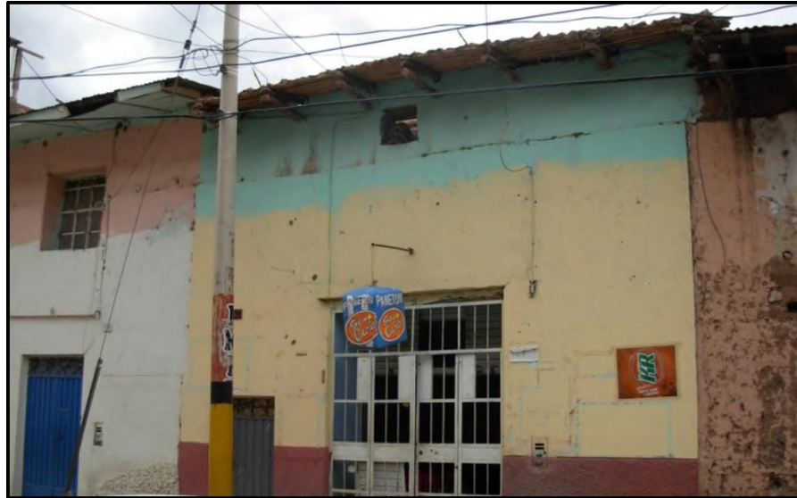
Figura 7.24.- Edificación con cubierta inestable de material liviano.
