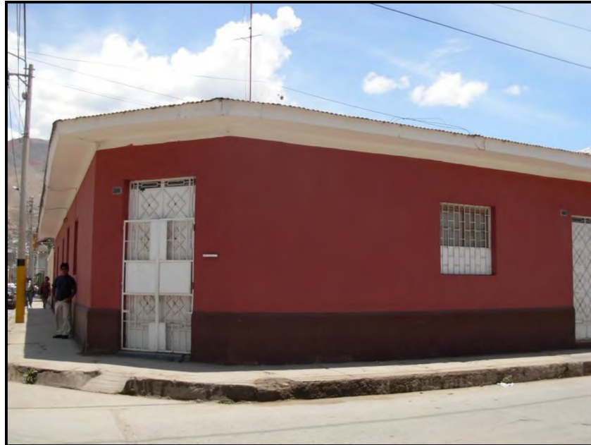
Figura 5.2.- Edificación de adobe de 1 nivel en buen estado de conservación con cobertura liviana de calamina.
