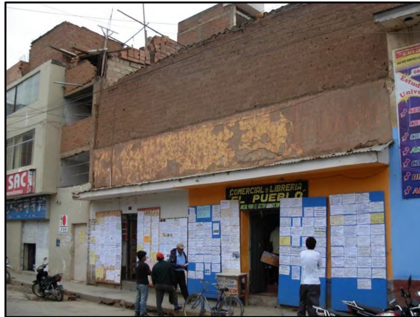
Figura 7.21.- Edificación de adobe con excesiva separación de muros.
