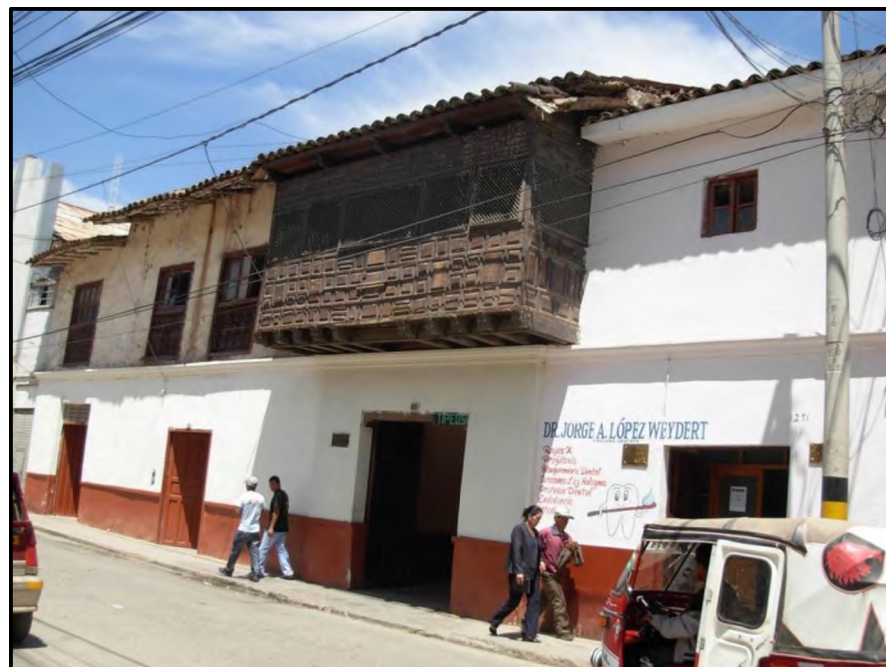
Figura 7.26.- Edificación de adobe con balcón en mal estado.
