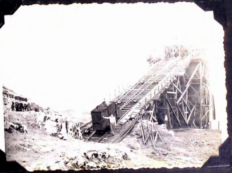
Foto 30.- Skip de izamiento en la plataforma de vaciado de las Tolvas de Pucará Arriba.
