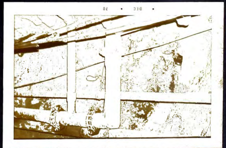
Instalación incorrecta de la línea de aire comprimido
