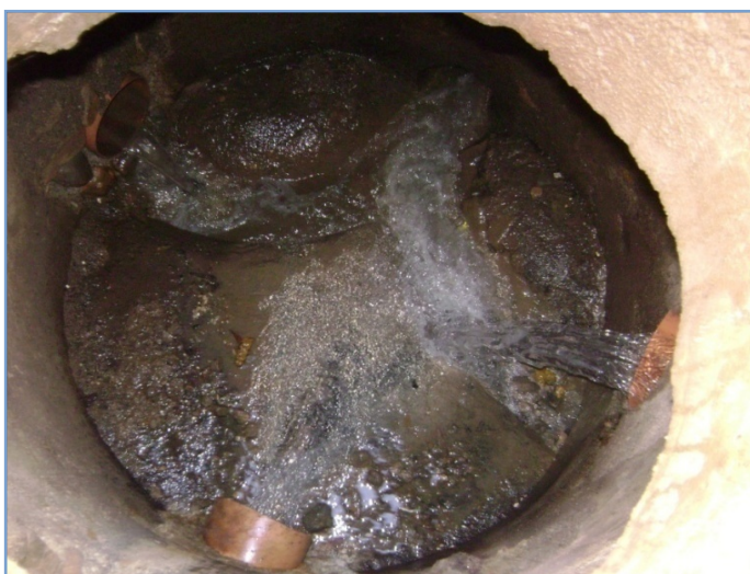
Foto 8. Buzón donde se empalman tuberías de PVC ejecutadas en el 2005 y que se empalman a un buzón en mal estado estructural
