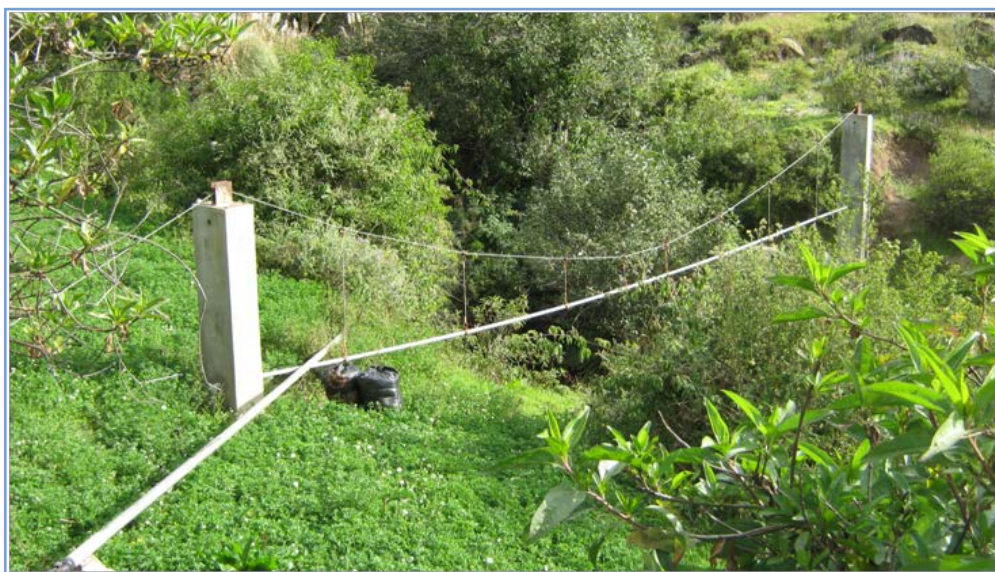
Foto 1. Línea de conducción N°01 y 02
