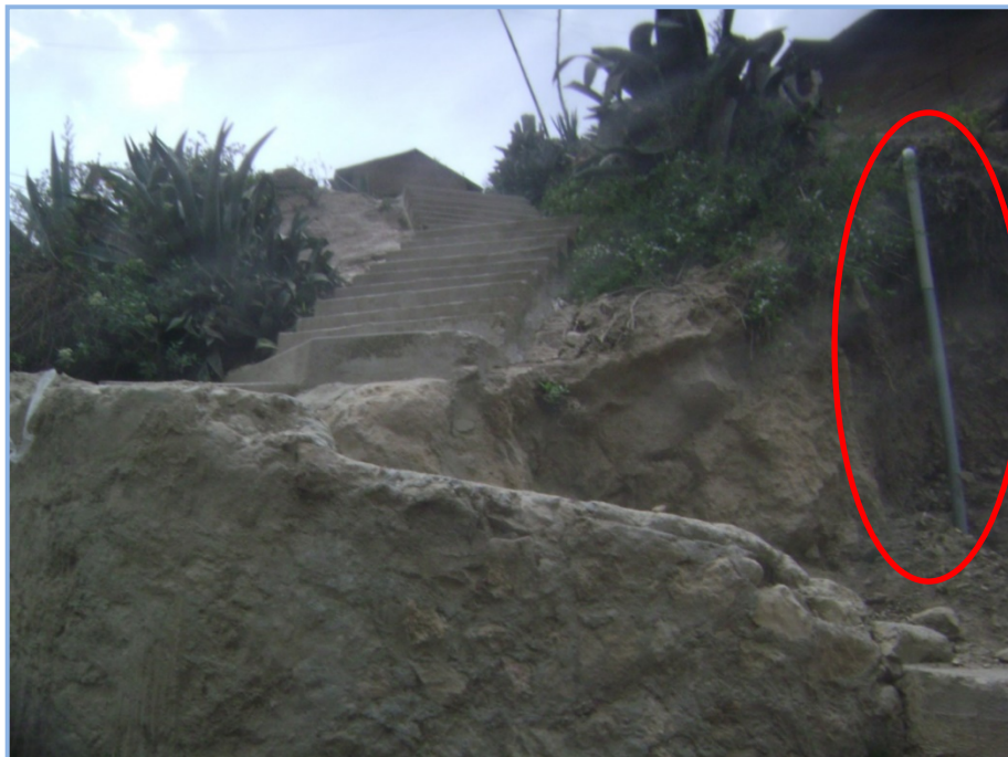
Foto N°4. En la instalación de redes de agua no se respetaron los criterios de construcción mínimos. Esto se traduce en un deficiente sistema de agua potable.
