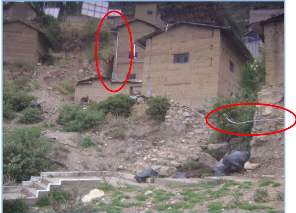
Foto N°3. Se aprecia múltiples tuberías de agua expuestas, lo cual las hace susceptibles a rupturas.
