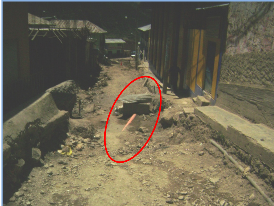
Foto N°5. Se aprecia la tubería de alcantarillado expuesta a roturas, no mantiene la cobertura mínima que estipula la norma.
