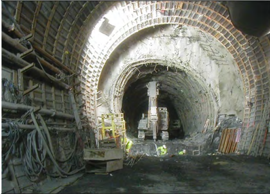
Fotografía 1: Fenómeno de Squeezing.
