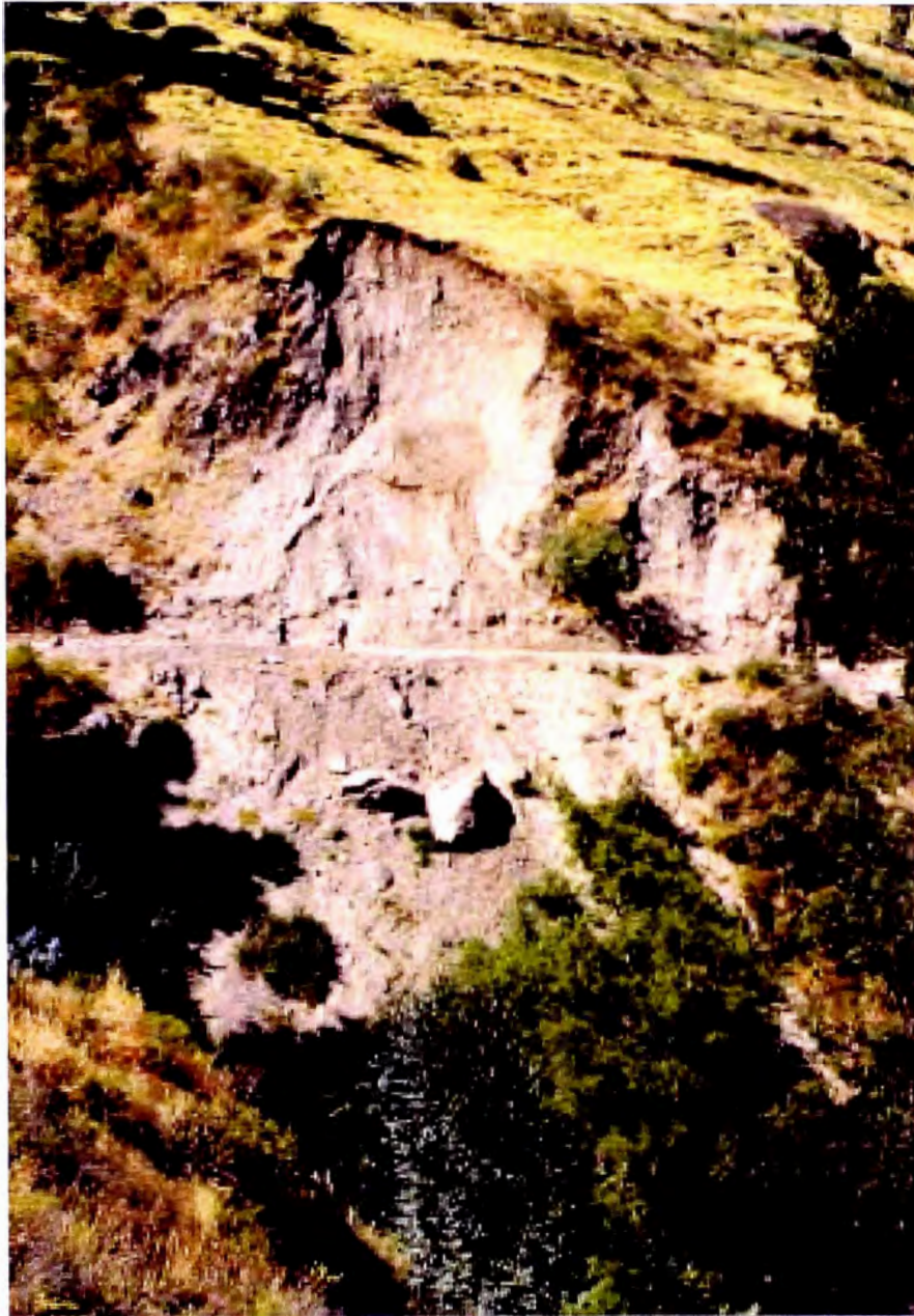
Foto N° 7.11 Derrumbe-Flujo a la altura del Km 2.5 de la carretera Huampara- Huanec.
