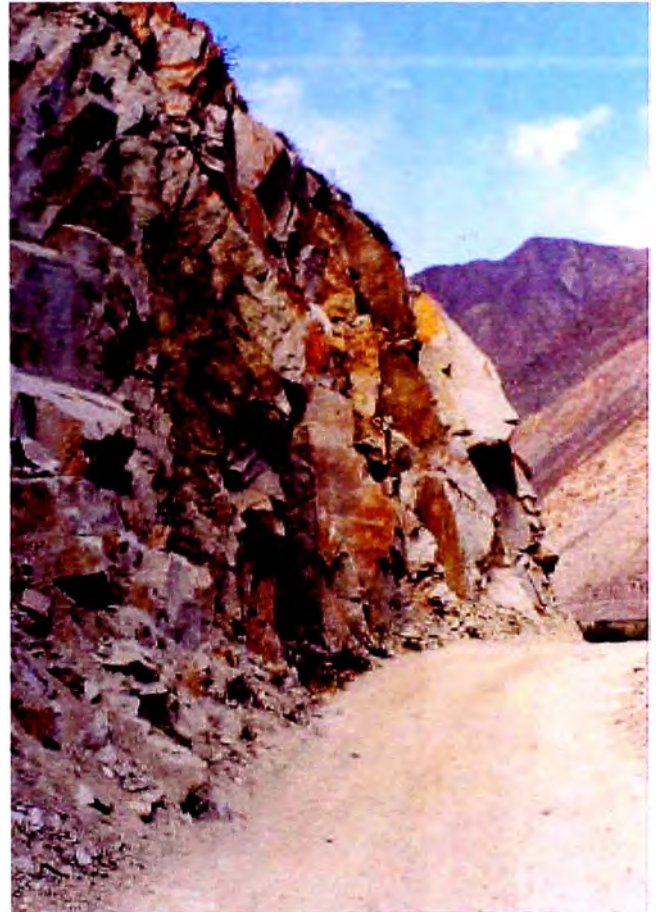
Foto N° 7.2 Caída de rocas ubicada, a la altura del Km 21 de la carretera Cayahuasi-Viscas, cerca al poblado de Viscas.
