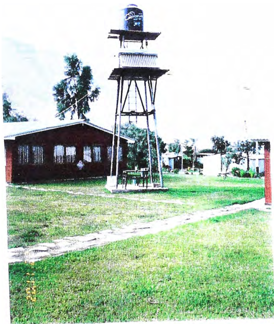
Foto 71.- Tanque de fibra elevado con panel solar para obtener agua caliente en las duchas de servicios higiénicos.
