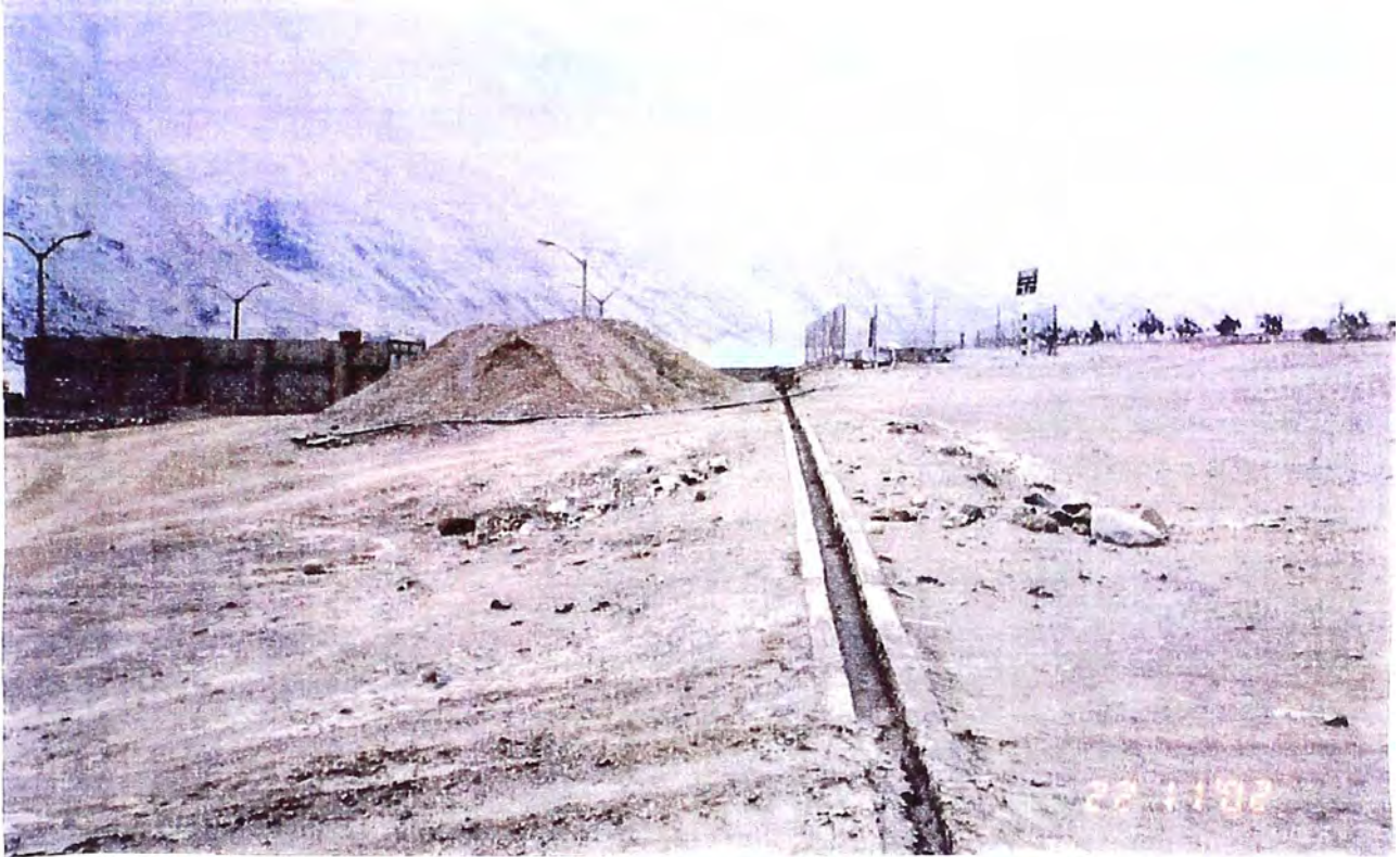
Foto 50- Canaleta de recepción de derrames de solución barren.
