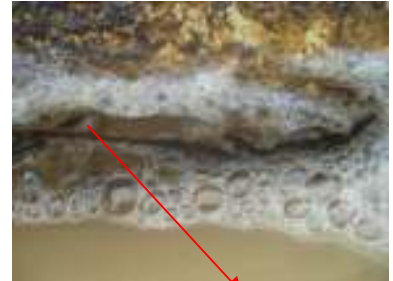
Presencia de lodo en las paredes del tanque de aireación
