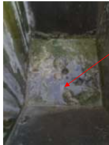
CAJA DE SALIDA DEL TANQUE DE AIREACION CON PRESENCIA DE ALGAS
