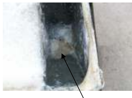
Formación de lodo a la salida del tanque aireado
