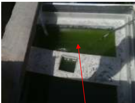
SEDIMENTADOR SECUNDARIO CON PRESENCIA DE ALGAS
