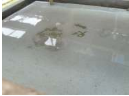
Sedimentador secundario (Con presencia de una capa de grasa blanca)
