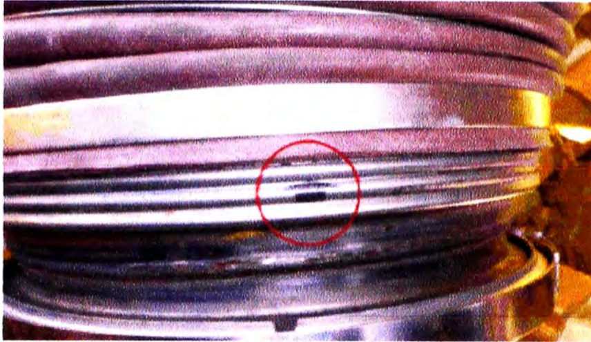
Figura N° 24 – Bellow (conector flexible) de escape que presenta rastros de fuga.
