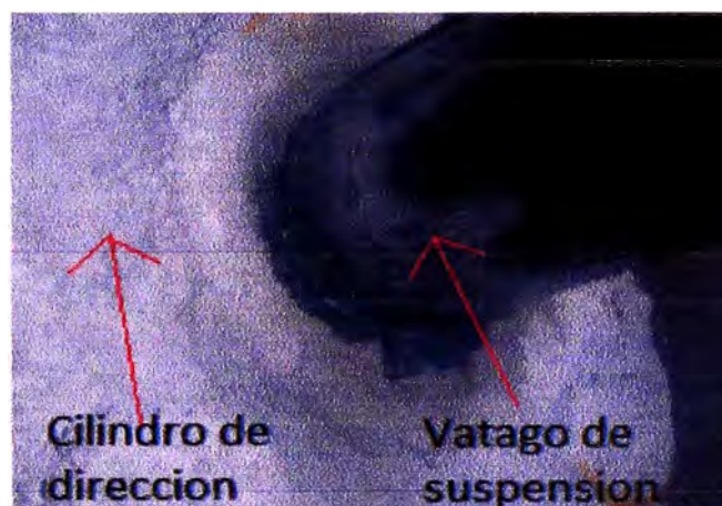
Figura N° 40 – Cilindro de dirección muestra fuga de aceite en forma leve.
