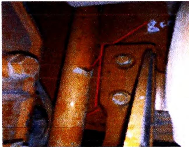
Figura N° 28 – Fisura en soporte de un enfriador del sistema de transmisión (fisura señalada por línea roja)
