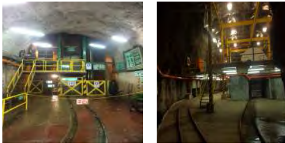
Figura 21: Pique Master, estación principal en el Nv. 4450, donde se transporta mineral a los diferentes niveles, la jaula es de 2 pisos, con capacidad para 30 personas. La Wincha Nro 01, tiene un motor de 300 HP, marca Nordberg.
