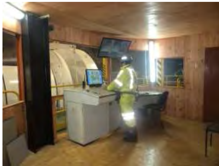
Figura 20: Pique Luz, Cabina de Control, Nivel 450. El Pique consta de una wincha de 1500 HP, trabaja con 2 skips de 7,5 TC y una jaula integrada en el skip Nro. 02 con capacidad para 9 personas.
