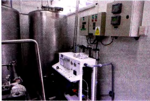
Figura 3.7. Equipo de ósmosis inversa de 3 etapas.
