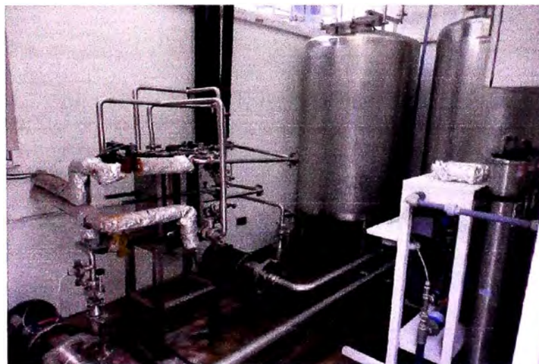
Figura 3.8. Tanques de almacenamiento de agua purificada, tuberías y bombas.
