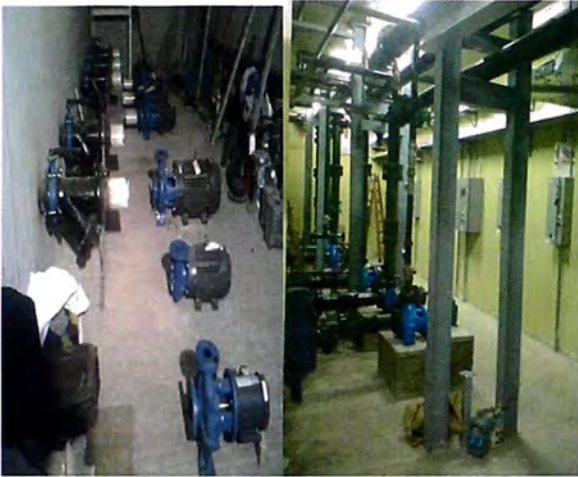
Cuarto de bombas
