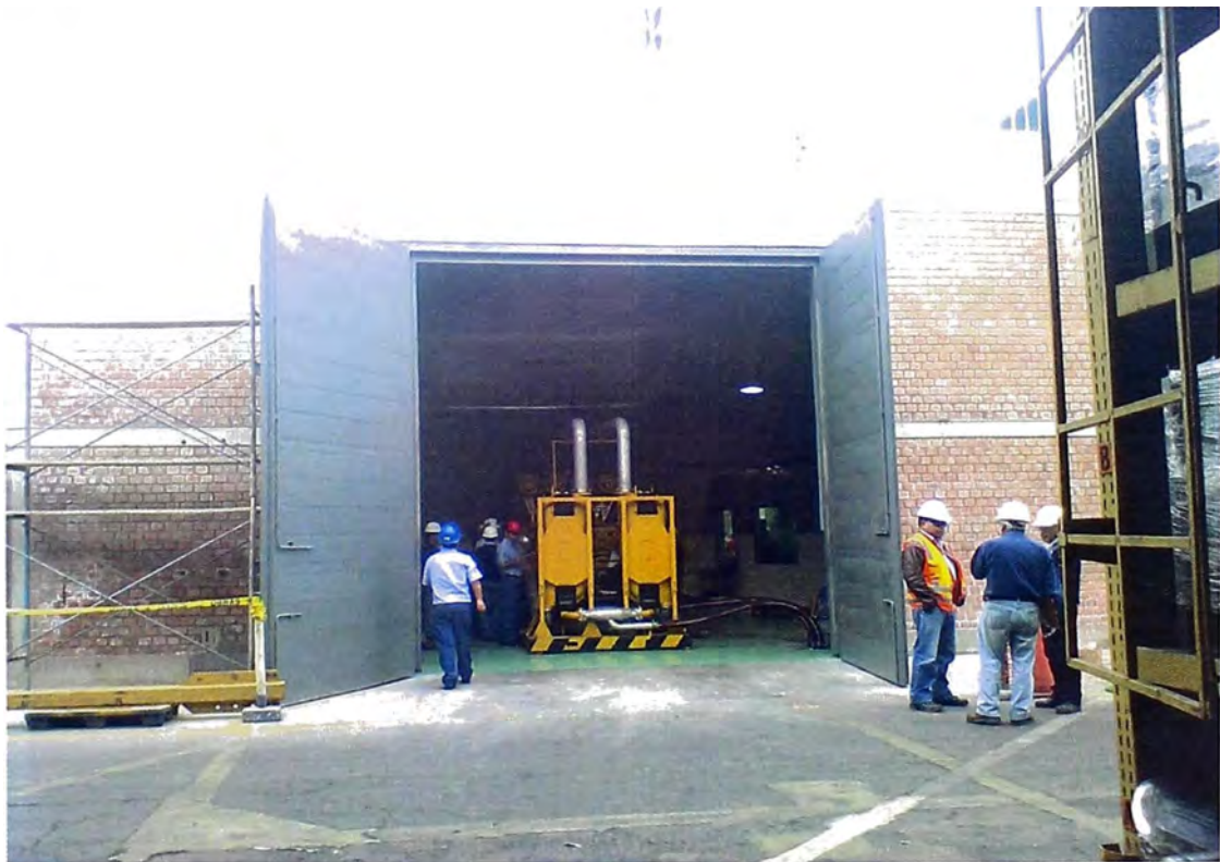
Ingreso de motor a sala de pruebas
