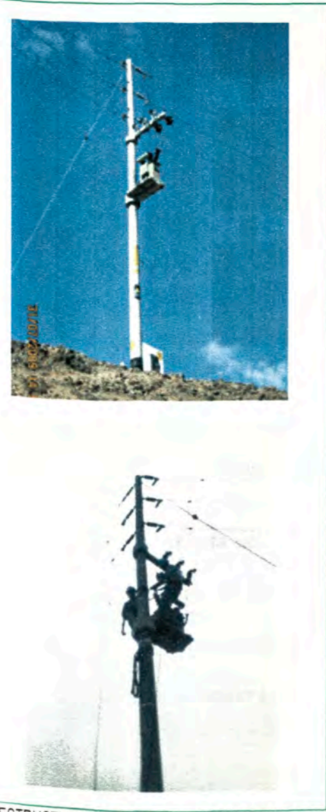
ESTRUCTURA DE MEDICION Y SECCIONAMIENTO
