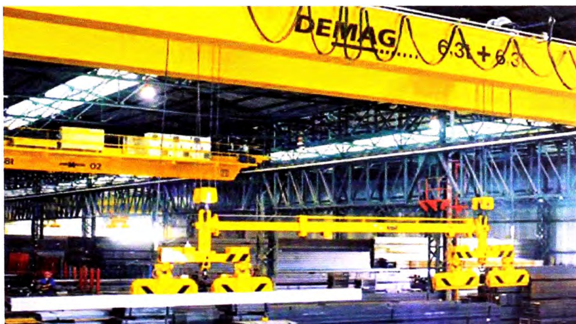
Fig. 2.16 Grúa puente para manejo de barras de acero
