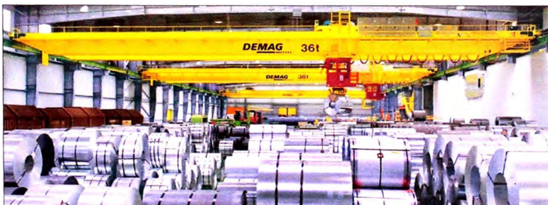
Fig. 2.13. Grúa puente especial para bobinas
