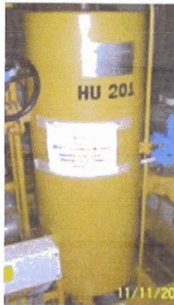
Filtros Duplex y Tanque de mezcla
