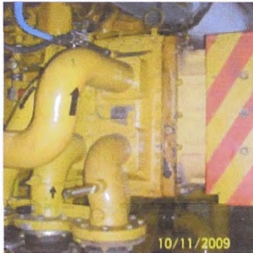
Enfriador de Aire (Aftercooler)
