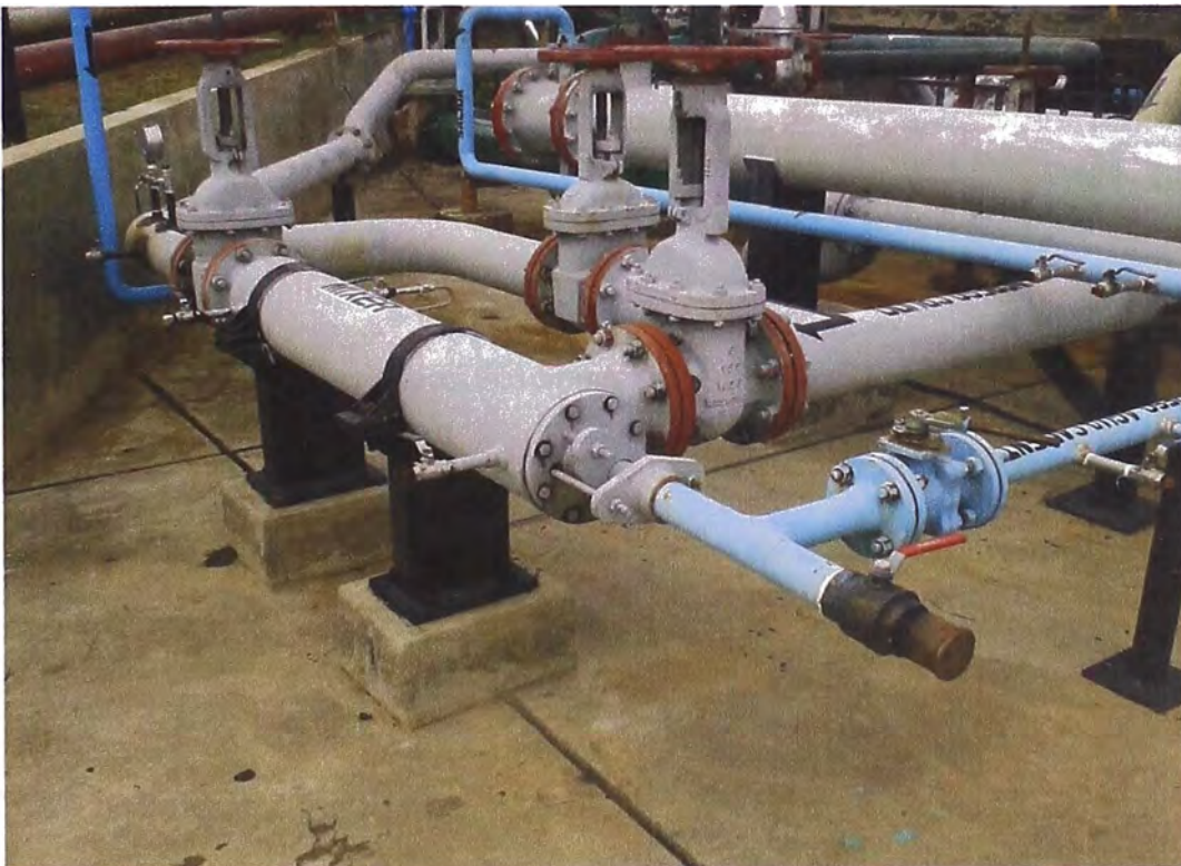
Figura 2.26: Mixer instalado en Batería 9
