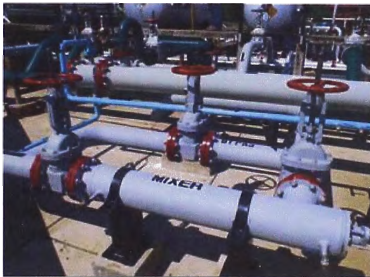
Figura 5.16: Mixer instalado en Batería 9
