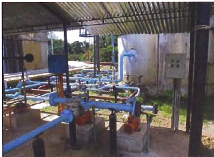
Figura 5.14: Electrobombas de agua
