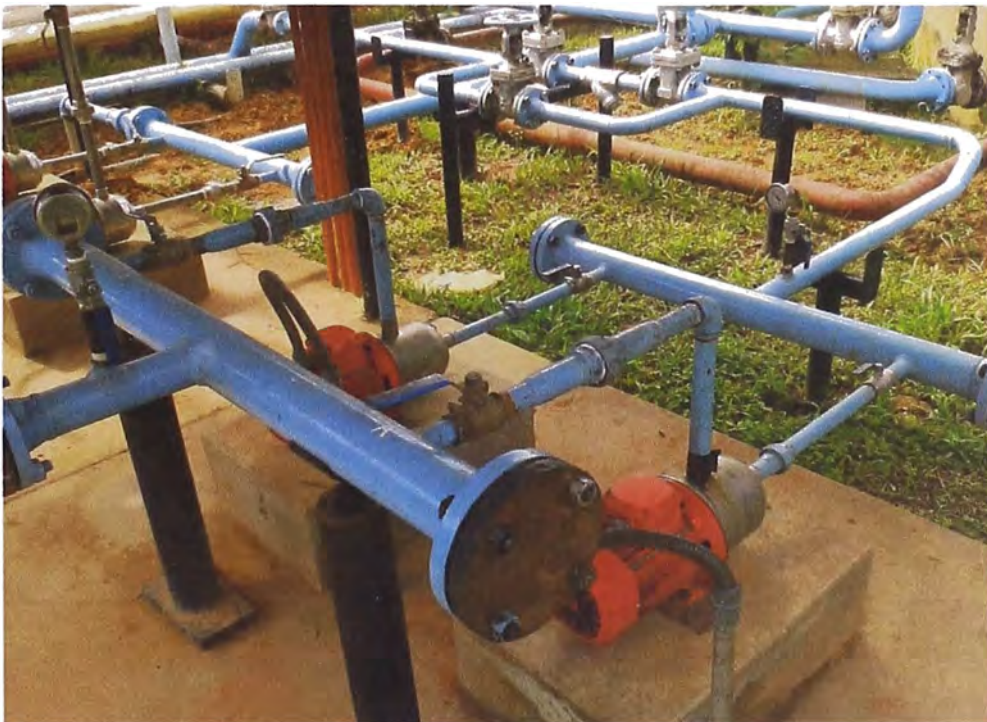
Figura 2.25: Interconexión de electrobombas y líneas de succión y descarga
