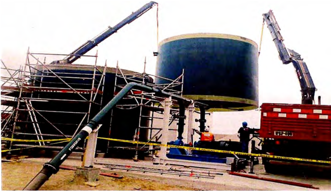
Figura 6.20 CILINDRO INFERIOR FIJADO SOBRE LA BASE DE CONCRETO Y MONTAJE DEL CILINDRO INTERMEDIO SOBRE EL CILINDRO INFERIOR.
