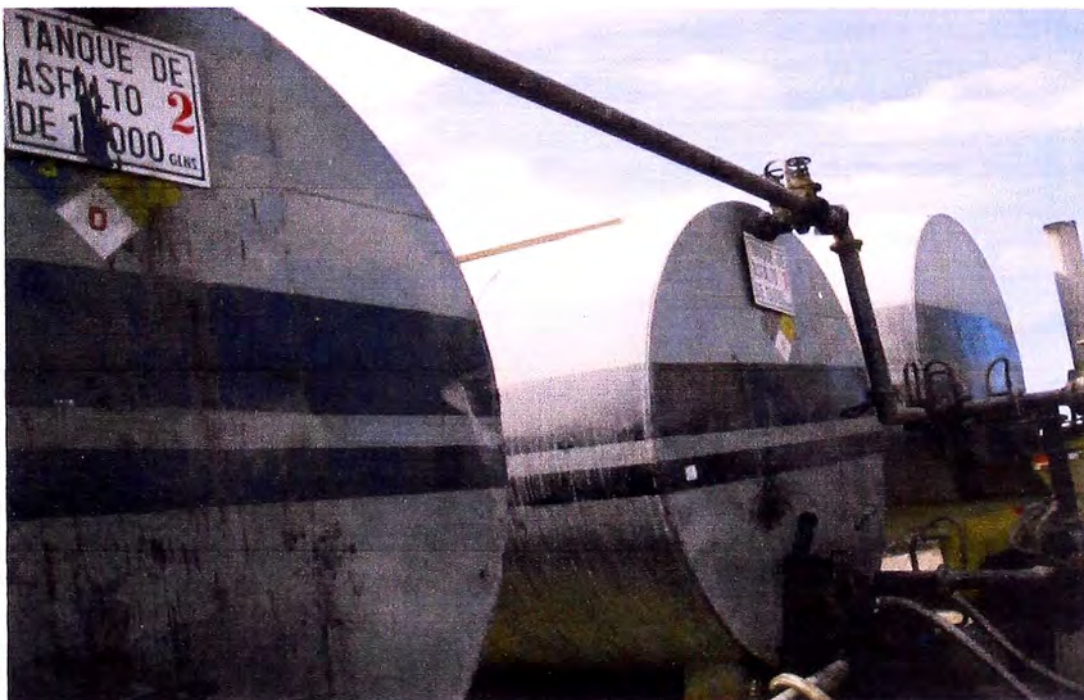
Fig. 3.9 Tanques de almacenamiento
