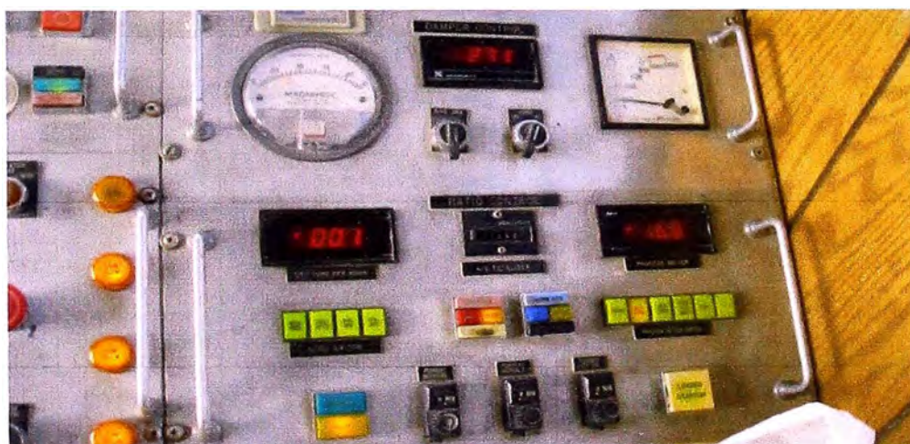
Fig. 3.15 Panel de control e indicadores de presión
