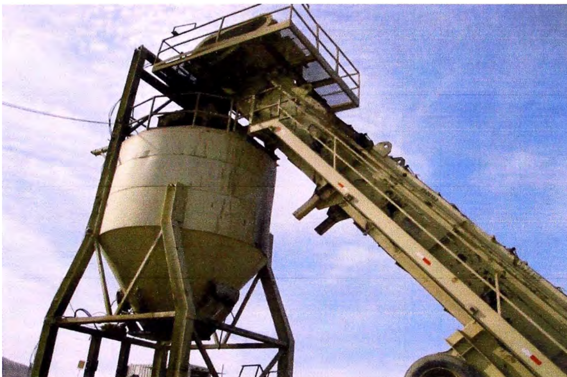
Fig. 3.13 Silo de almacenamiento
