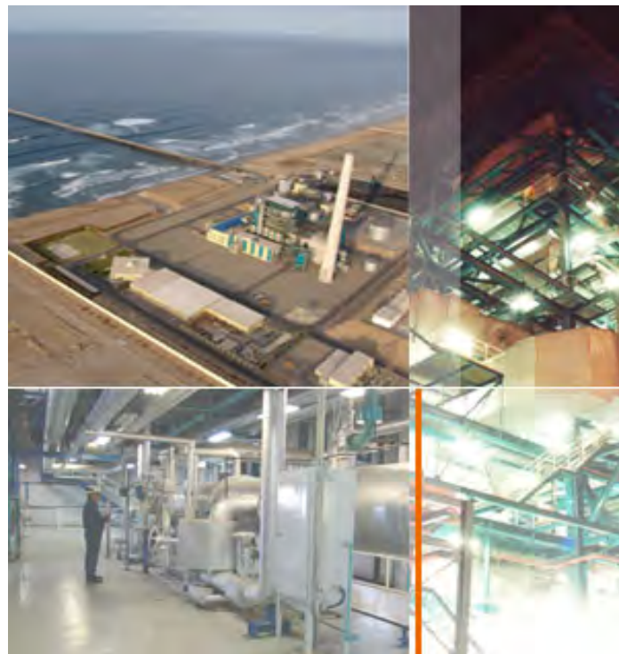
Figura 3.03. Vista Interior de las Instalaciones de Central Termoeléctrica ILO21
