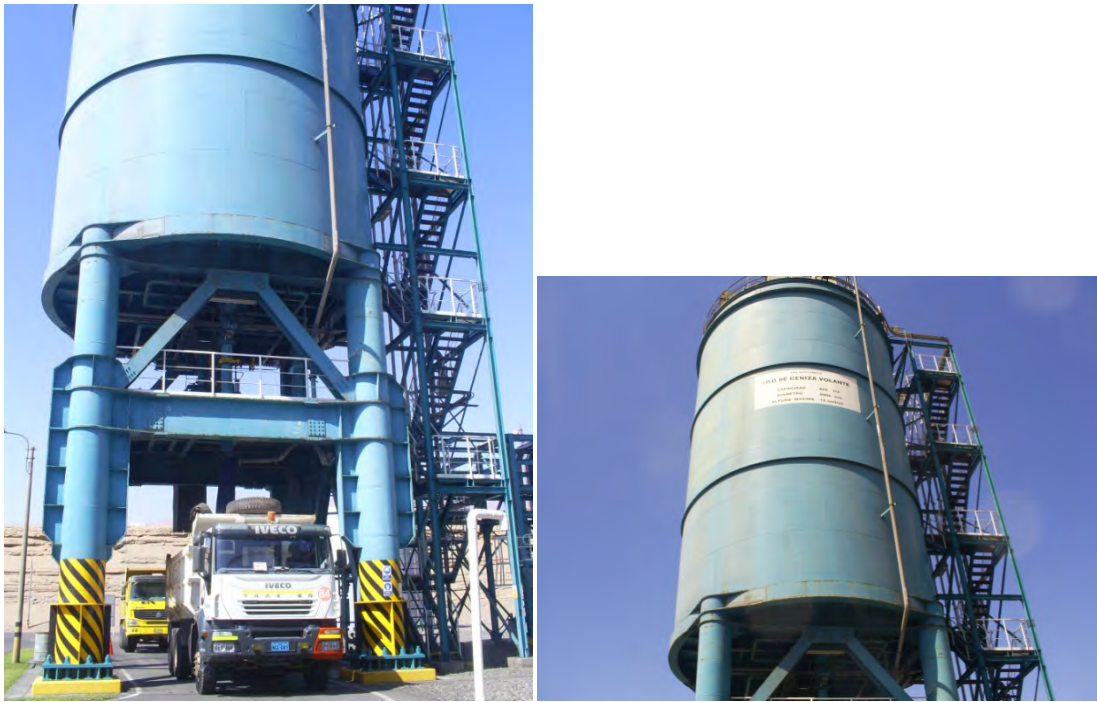
Figura 3.04: Vista de los Silos donde se Almacena la Ceniza Volante
