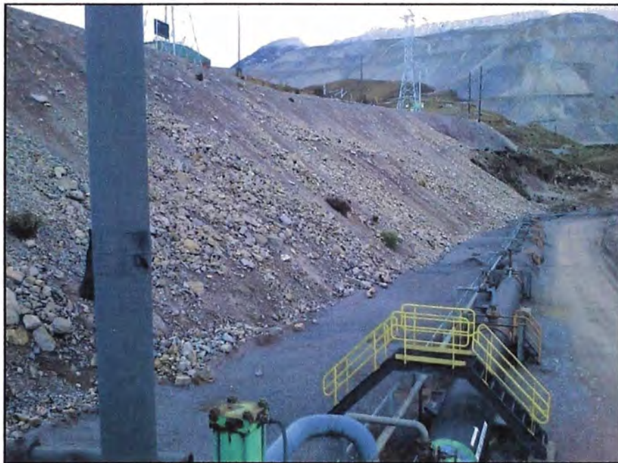
Figura 2.3 Fotografía tomada a la tubería de conducción de los relaves mineros utilizando tubería con diámetro de 58" HDPE SDR 21
