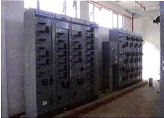
Figura 2.16 Centro de Control de Motores de Bocatoma Huachipa
