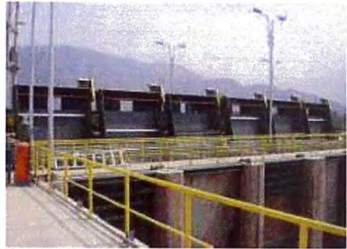
Figura 2.9 Vista frontal de sistema de limpiador de rejillas
