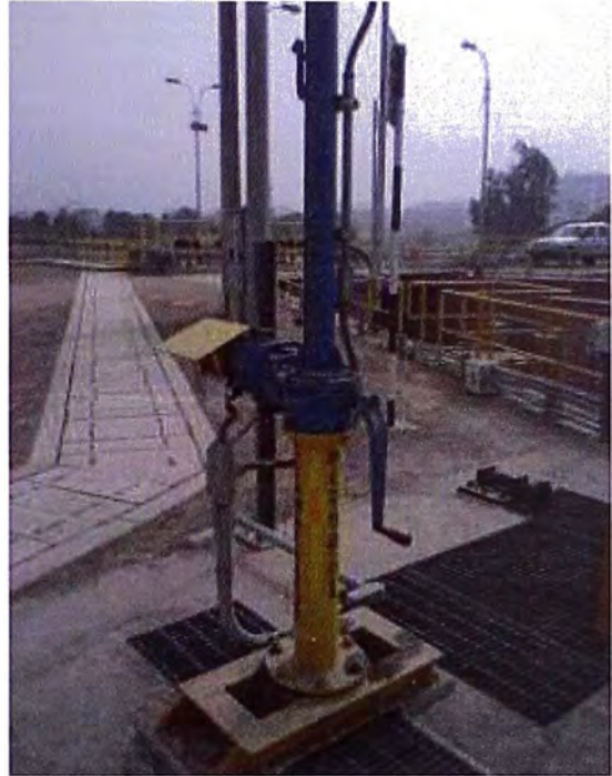
Figura 2.12 Accionamiento eléctrico de compuerta plana deslizante
