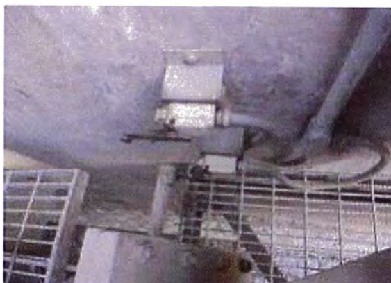
Figura 2.29 Ubicación de final de carrera en compuerta de Aliviadero
