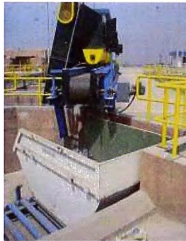
Figura 2.10 Depósito de basura instalado en sistema de limpiador de rejillas
