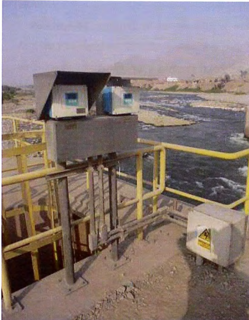
Figura 2.39 Ubicación final de transmisores de turbiedad
