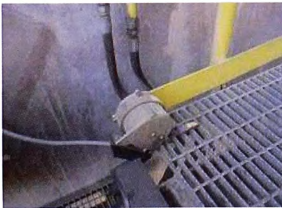
Figura 2.26 Ubicación final de sensor de posición angular en compuerta de Aliviadero
