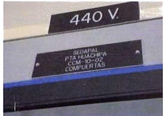
Figura 2.17 Rotulado de CCM de compuertas de Bocatoma Huachipa
