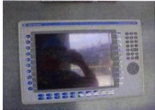
Figura 2.50 Arreglo final de PanelView en tablero PLC
