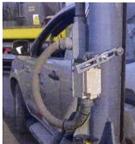
Figura 2.30 Ubicación de final de carrera en compuerta plana deslizante
