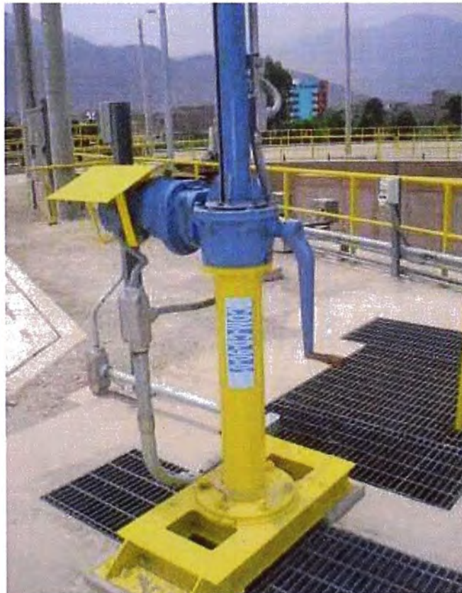
Figura 2.23 Arreglo final de caja de reducción de compuerta plana deslizante
