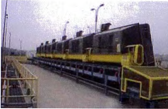
Figura 2.8 Vista posterior de sistema de limpiador de rejillas
