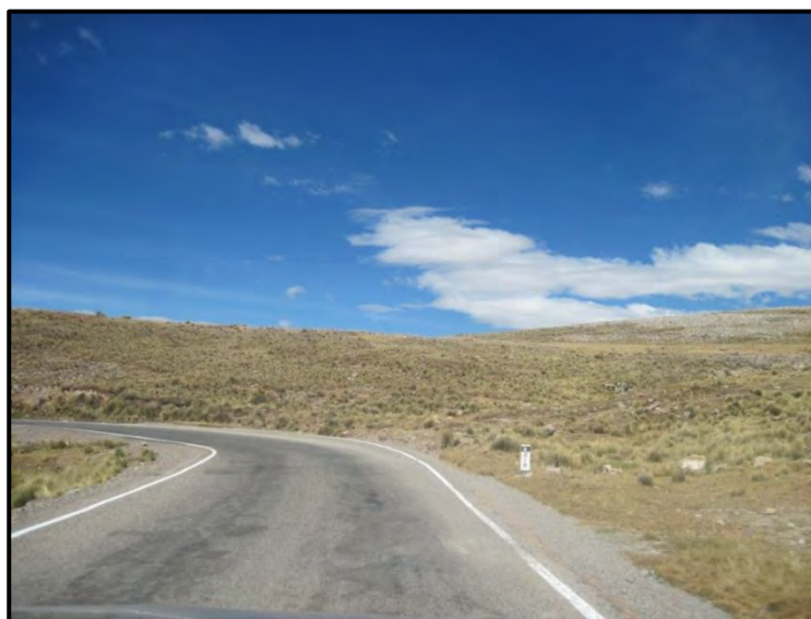
Foto 4.3. Talud con riesgo bajo ubicado en el Km 218+000
