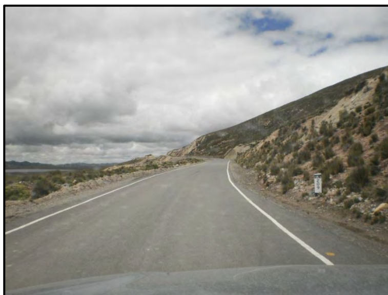
Foto 4.4. Talud con riesgo moderado ubicado en el Km 209+000
