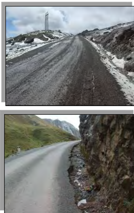
Foto 2.2. Socavación en cuneta sin revestir que reduce la sección de la vía
