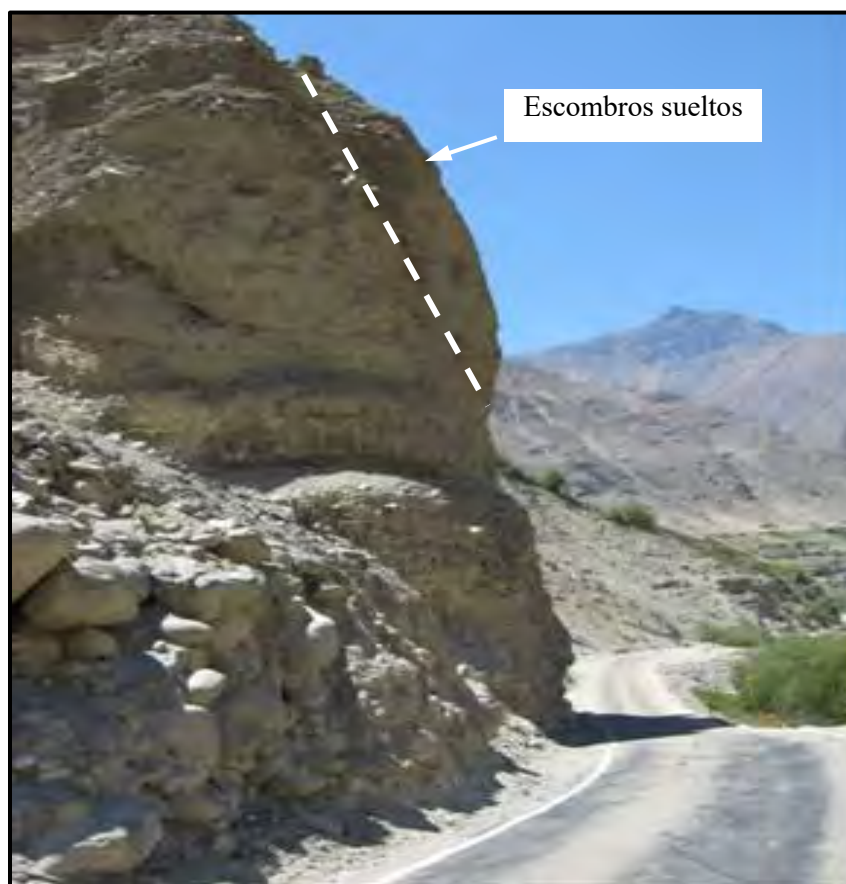
Foto 4.5. Talud con riesgo alto ubicado en el Km 81+640
