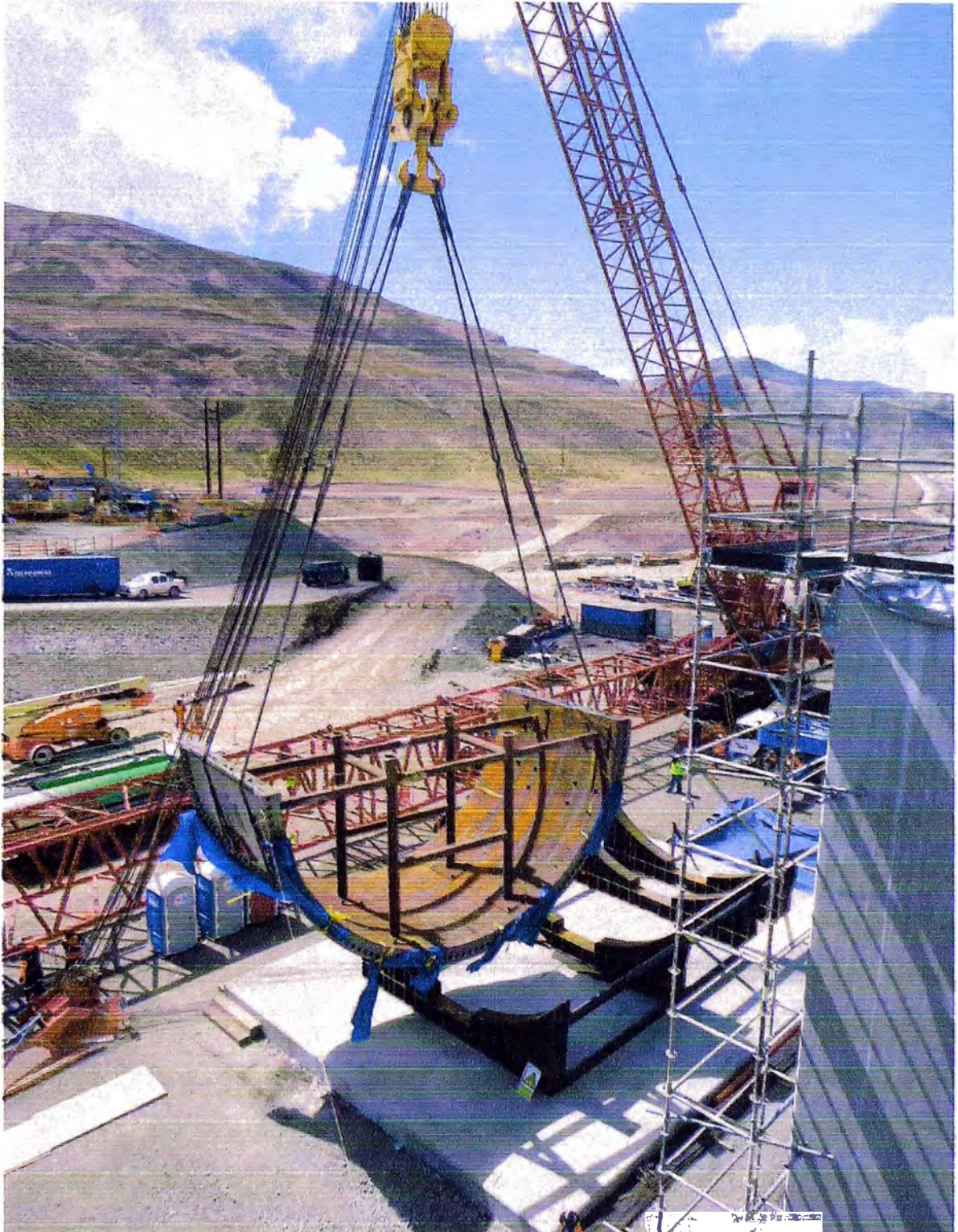
Figura 2.7: Ejemplo pre-armado de shell de molino de bolas, montaje sobre cunetas a nivel de terreno con grúa de celosía en planta concentradora Toromocho
