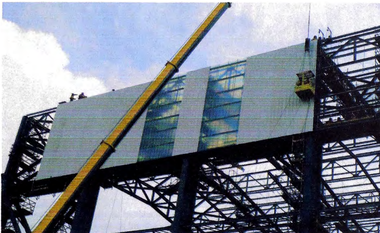
Figura 2.12: Ejemplo de montaje de coberturas con grúa hidráulica en edificio de molienda en planta concentradora Toromocho
