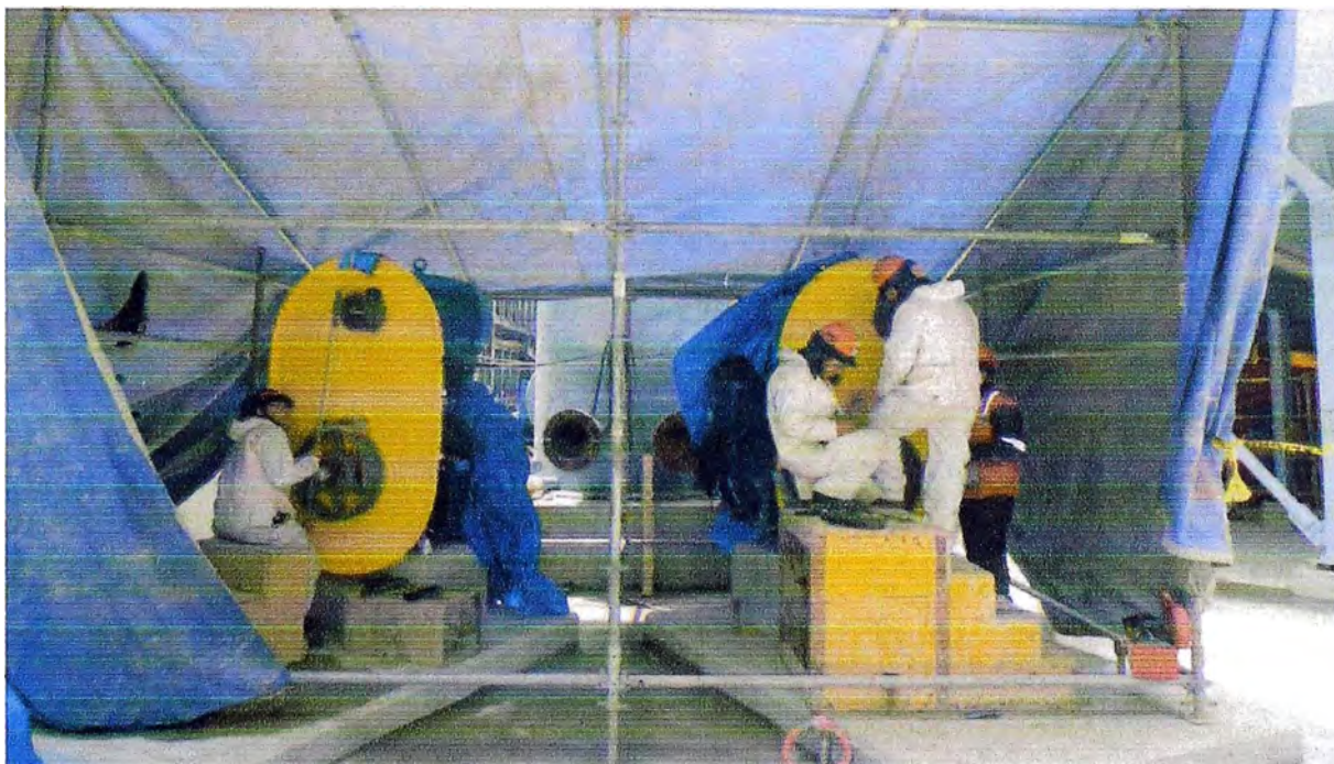
Figura 2.13: Ejemplo de alineamiento de bomba centrífuga con reducción por fajas, trabajos de cierre en bomba centrífuga en planta concentradora Toromocho
