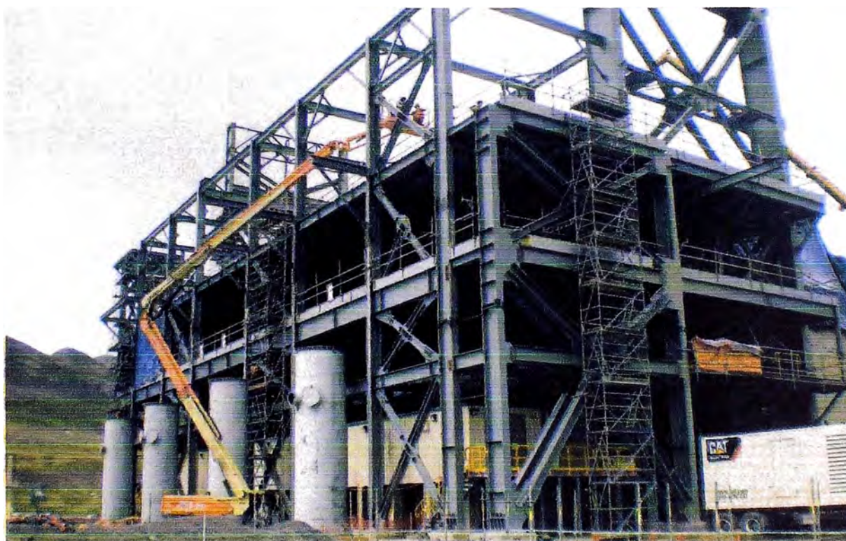
Figura 2.15: Ejemplo de instalación de pernos con plataforma elevadora manlift, trabajos de cierre de estructuras de edificio de molinda en planta concentradora Toromocho
