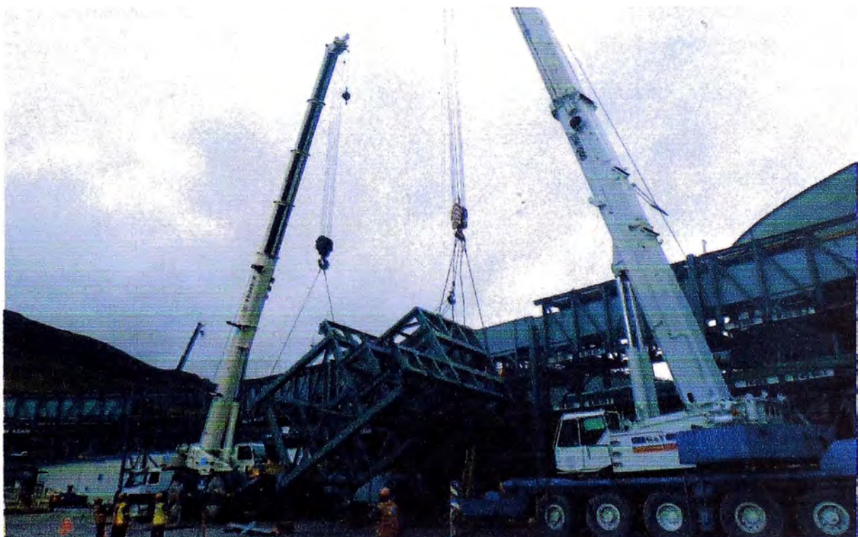
Figura 2.11: Ejemplo de montaje con 2 grúas hidráulicas de estructura de acero pre-armada a nivel de terreno en planta concentradora Toromocho
