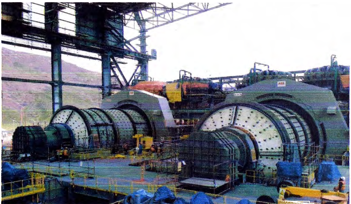
Figura 2.2: Vista de molinos de bolas de 28'x44' y 2,625 toneladas por hora de capacidad c/u en planta concentradora Toromocho
