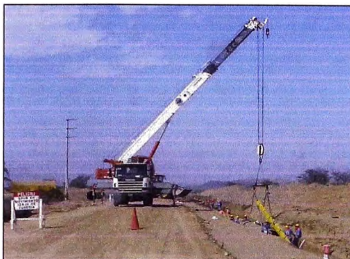
Figura N° 4.5: Interferencia de trabajo por equipos de descarga de otros frentes de trabajo.
