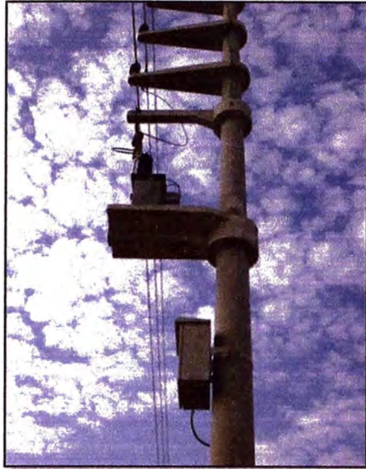
Figura N° 2.14: Subestación Monoposte. Fuente OPIC.
