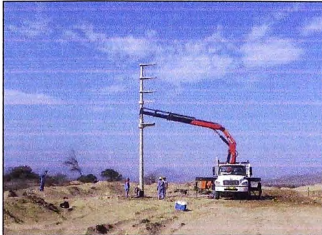
Figura N° 4.8: Equipos no apropiados para la zona geográfica de trabajo.
