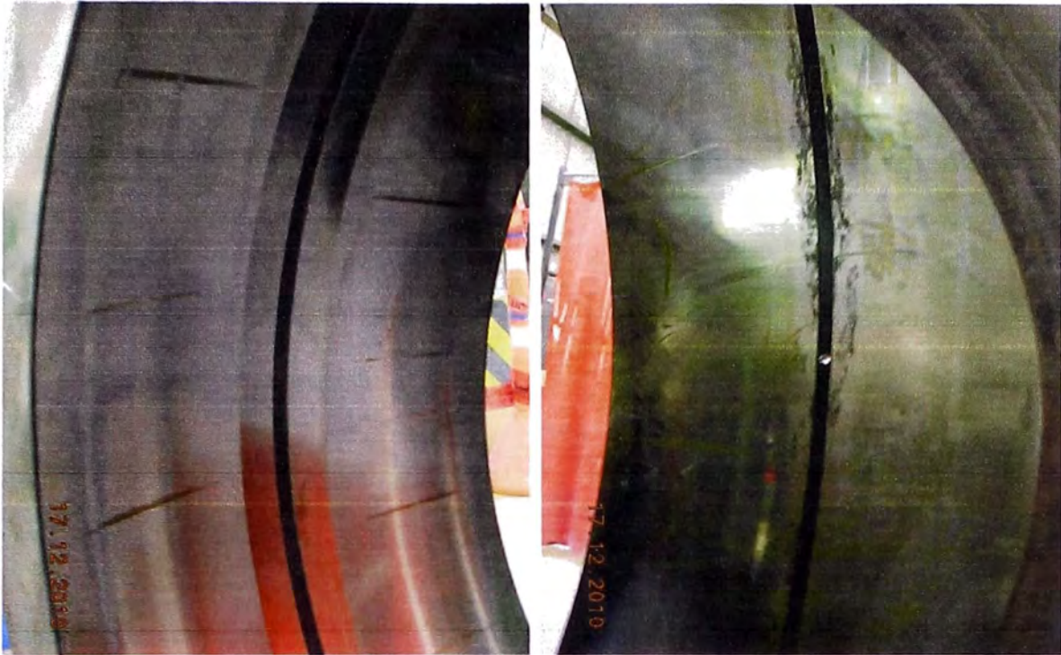
Fig. N° 5.77 Standstill – Corrosión localizada por contacto de rodillo a distancia de separación por efecto de humedad durante paradas prolongadas.
