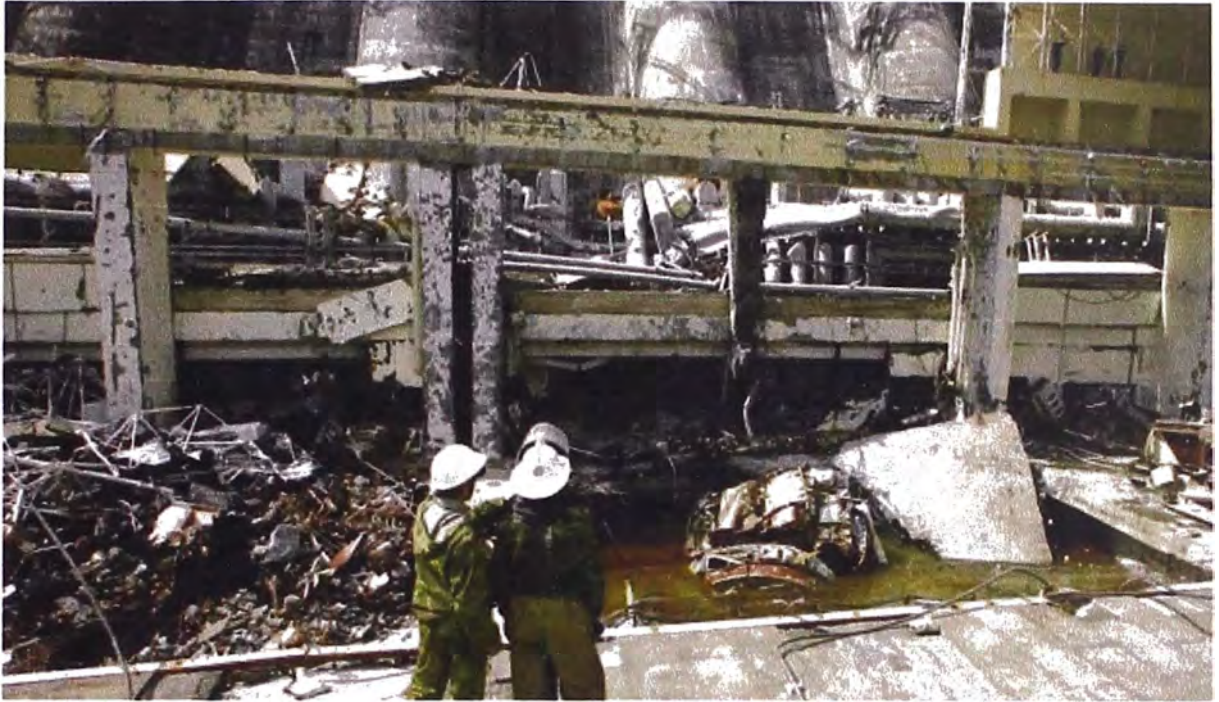
Fig.1. Daños causado en la parte intermedia de la central hidroeléctrica
