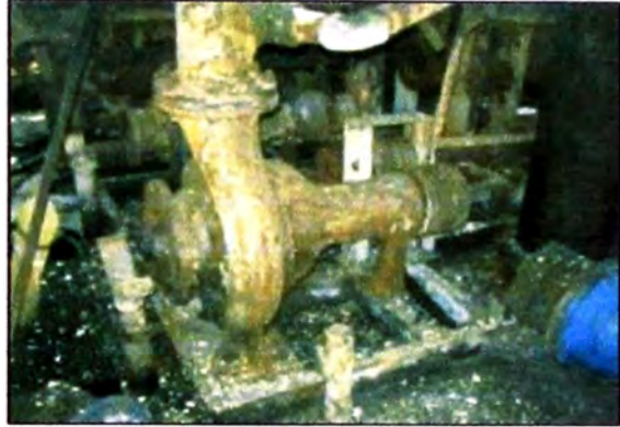
Foto 3.8 Daños en bomba de ceba
