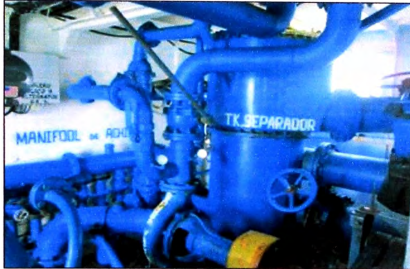
Foto 5.10. Sistema de bombeo centrifugo
