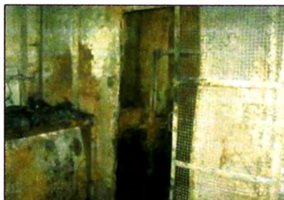
Foto 3.12 Daños en acomodación
