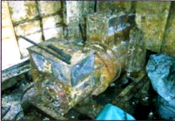
Foto 3.7 Daños en motor grupo
