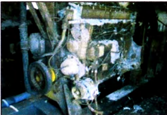
Foto 3.9 Daños en motor Auxiliar
