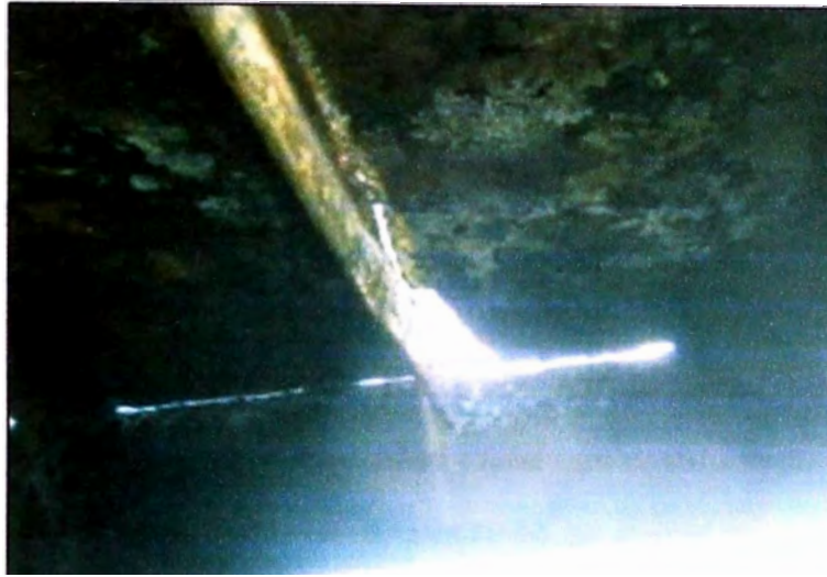
Foto 3.5 Daños en cubierta principal
