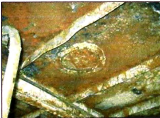
Foto 3.3 Daños cubierta caseta pr.
