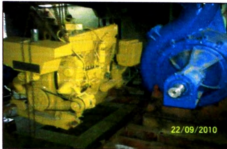
Foto 5.8. Motores y bombas Línea babor
