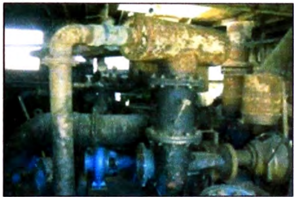
Foto 3.10 Daños en tuberías
