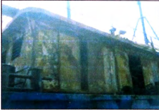
Foto 3.1 Daños en caseta proa
