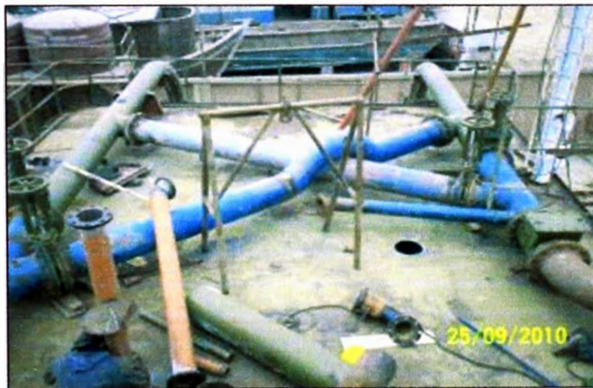
Foto 5.11. Tuberías de descarga
