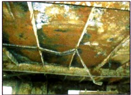
Foto 3.4 Daños cubierta caseta pp.
