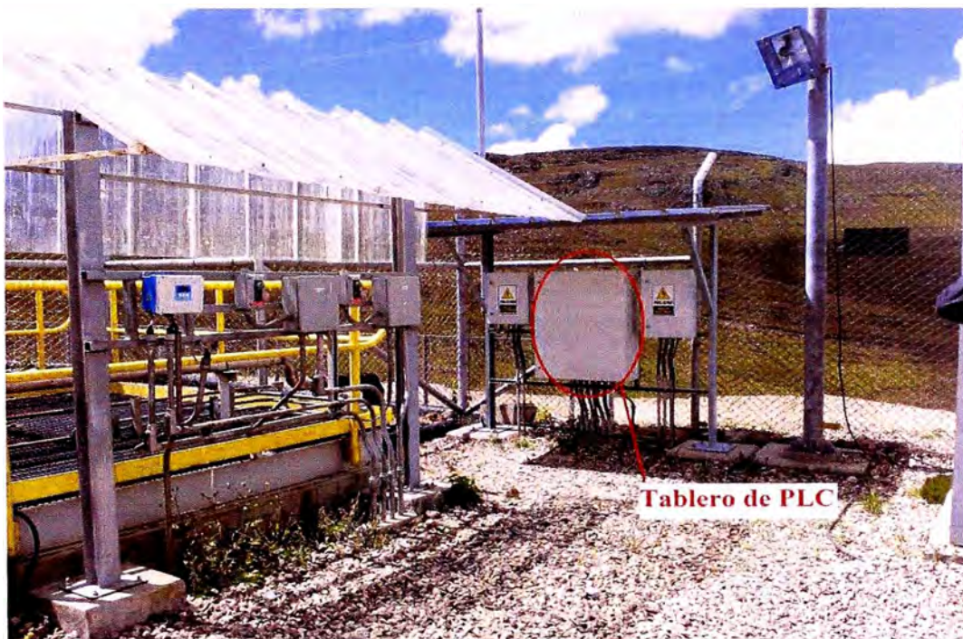
Figura 3.17. Ubicación de tablero de PLC en campo
