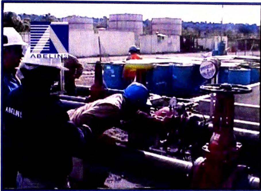
FOTO: De derecha a izquierda Sr Ricardo Rezzonico de Techint S.A. y Enrique Carcahusto ABELIN S.A. revisando las instalaciones realizadas. Junio 2008
