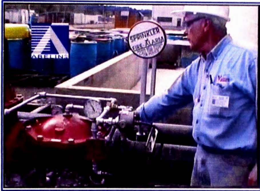
FOTO: Personal de Chemguard – Vector Fire Fay Purvis, inspeccionando una válvula diluvio DV5 instalada en el sistema de espuma contraincendio. Junio 2008
