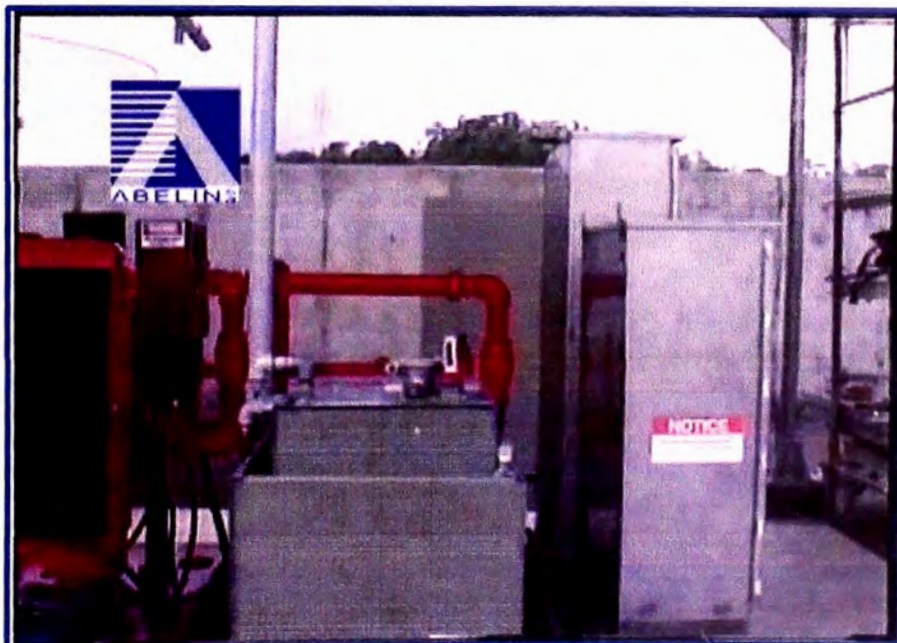
FOTO: Skid proporcionar/ dosificador de concentrado de espuma, tableros de control de operador y depósito de combustible.
