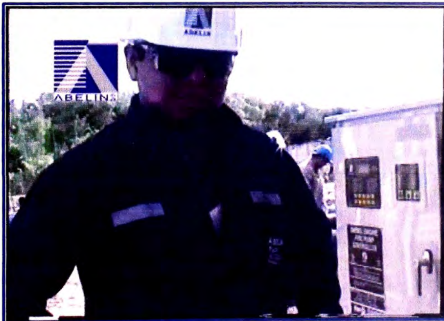
FOTO: Enrique Carcahusto ABELIN S.A. frente al tablero de operador del skid proporcionador /dosificador de concentrado de espuma. Junio 2008
