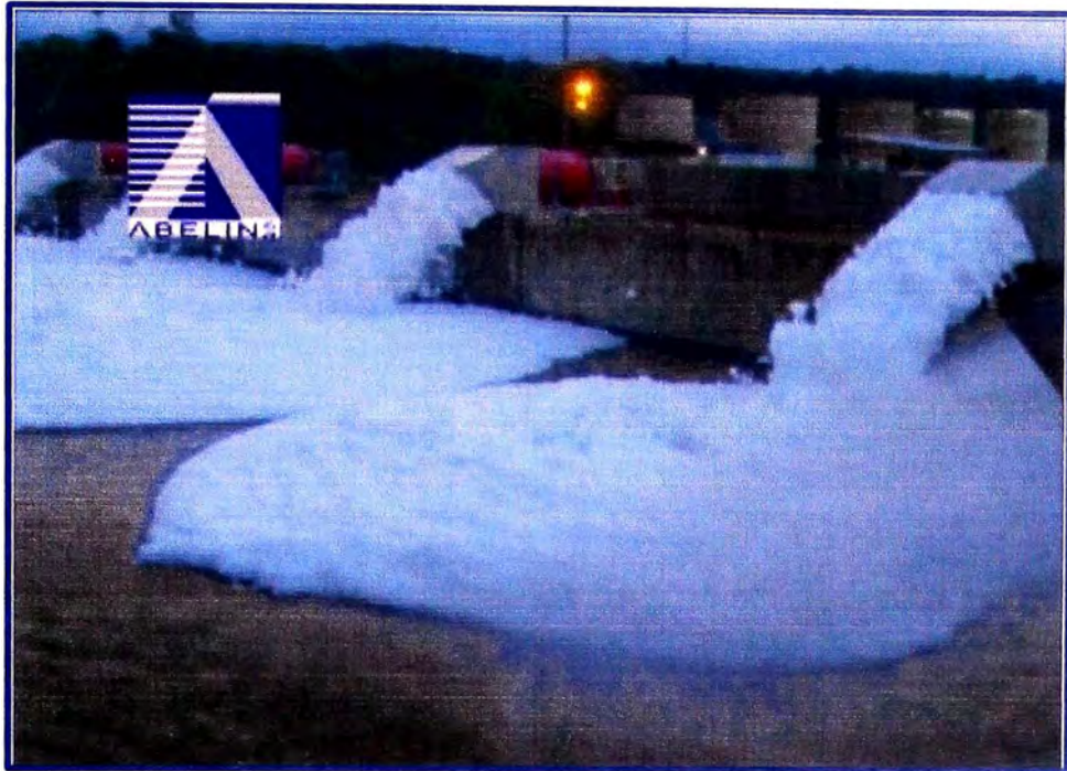
FOTO: Sistema de Espuma contraincendio de alta expansión en pleno funcionamiento. Junio 2008.
