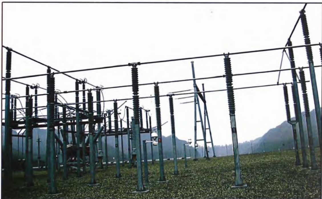
Imagen 5.3 Equipo del aislador más el soporte estructural
