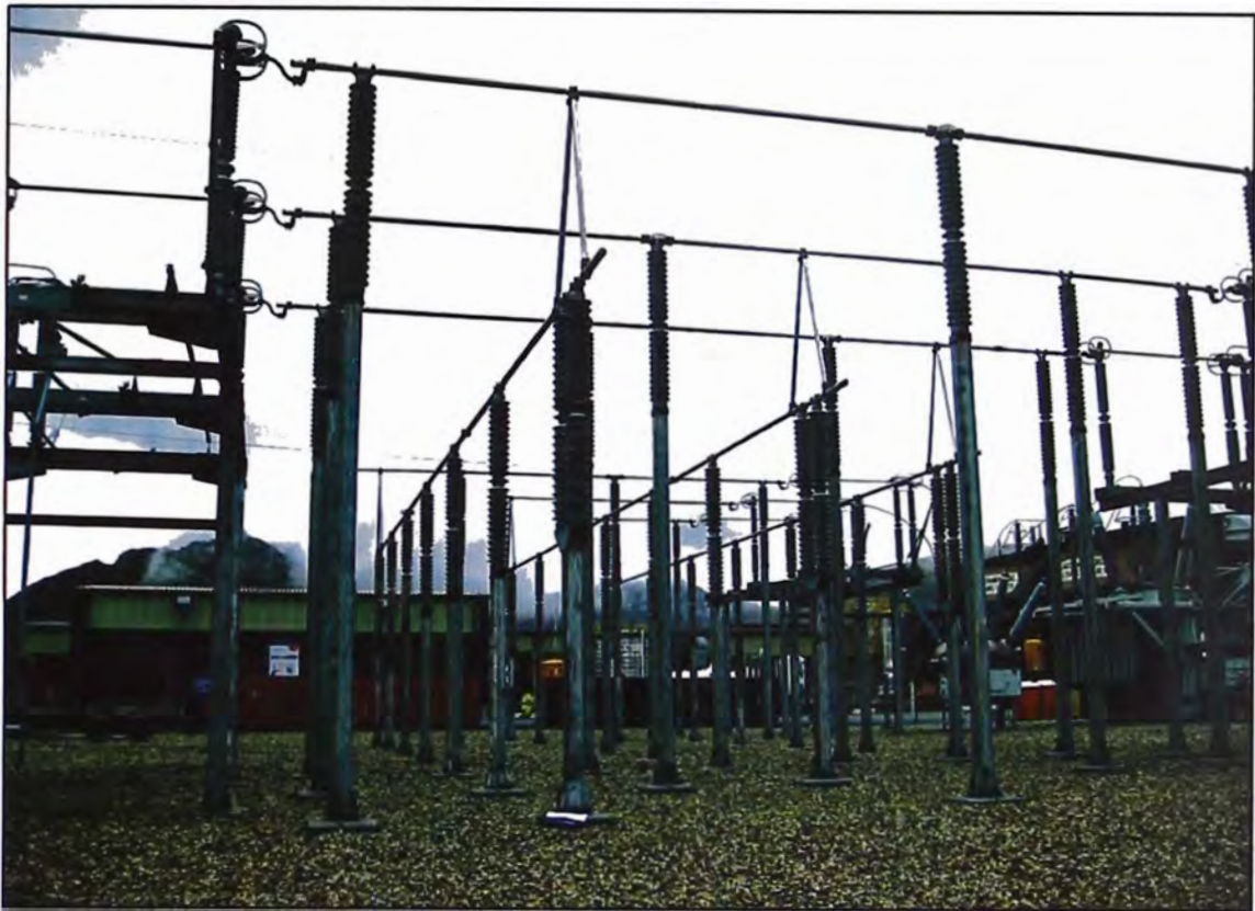
Imagen 5.2 Subestación eléctrica de la Minera
