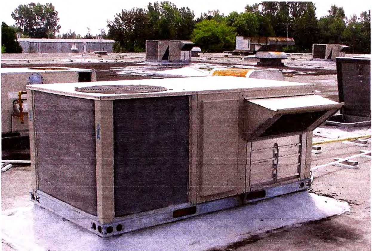
Fig: 2,3 Equipo Roof top.
