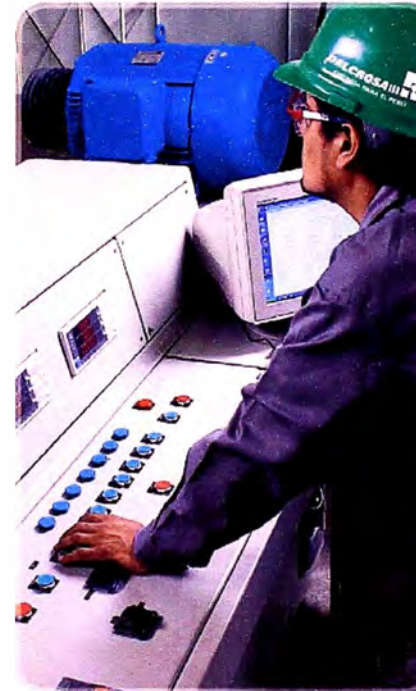
• Tablero de comando y medición
