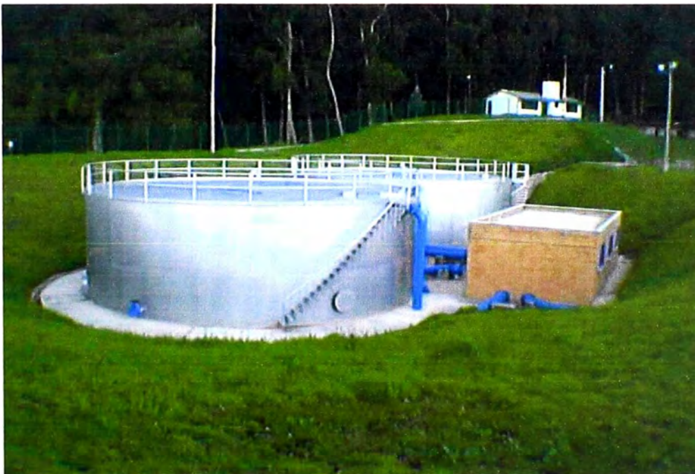
Figura 3.1 Tanque de Almacenamiento Atmosférico.
