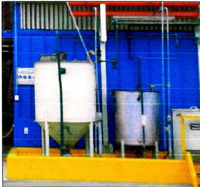
Fig. 3.2 Tanques de agua blanda y lubricación
