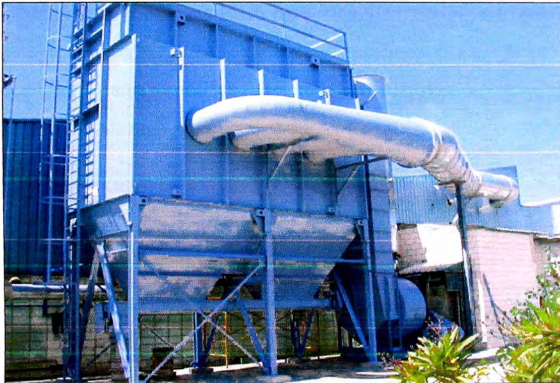
Fig. 2.3 Filtro de Mangas del Ciclón
