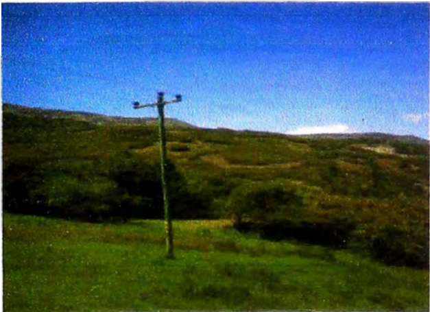
IE-Linea trifasica de 22.9KV en poste de madera en la localidad de Sausalito de Marra
