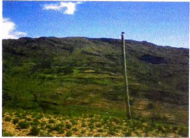
IE-Línea monofásica MRT de 13.2KV en poste de madera en la localidad de Suro
