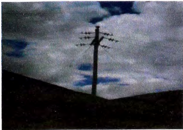
IE-Línea trifásica de 22.9KV en poste de madera en la localidad de La Cruz-Sector Shita
