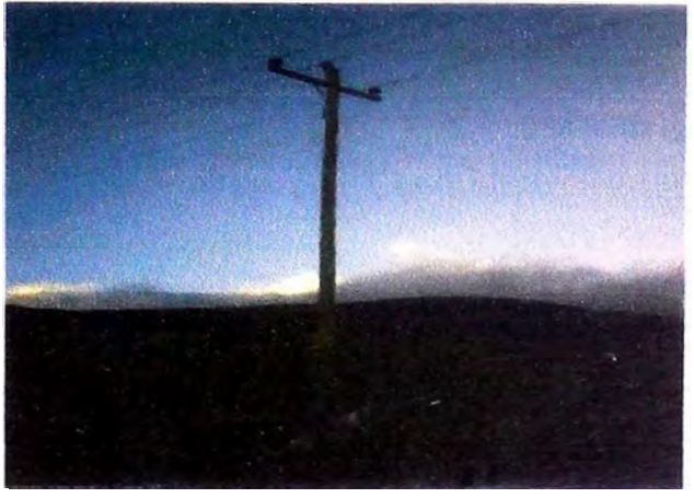
IE-Linea trifasica de 22.9KV en poste de madera en la localidad de Totora
