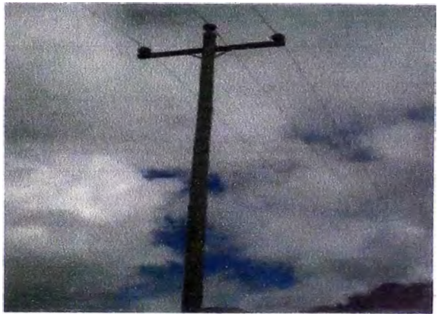
IE-Linea trifasica de 22.9KV en poste de madera en la localidad de Yuracpirca
