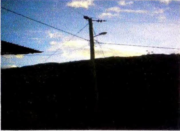
IE-Línea monofásica de 13.2KV con pastoral y red secundaria 220V en poste madera en Catillambi
