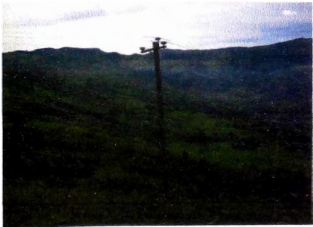
IE-Linea trifasica de 22.9KV en poste de madera por la localidad de Chirigual
